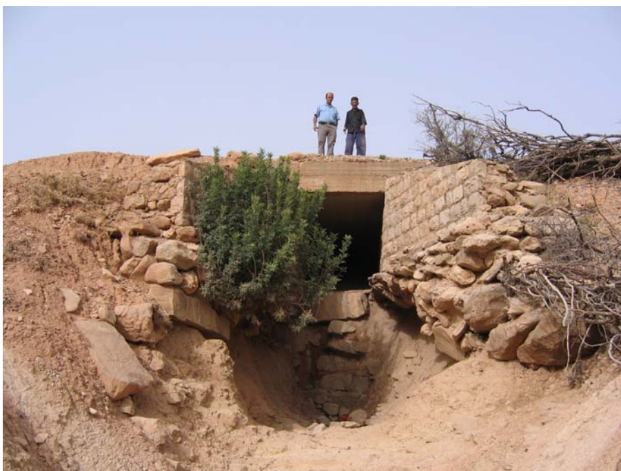
تصویر ۷: تخریب جاده و سازه های آن در اثر سیل
