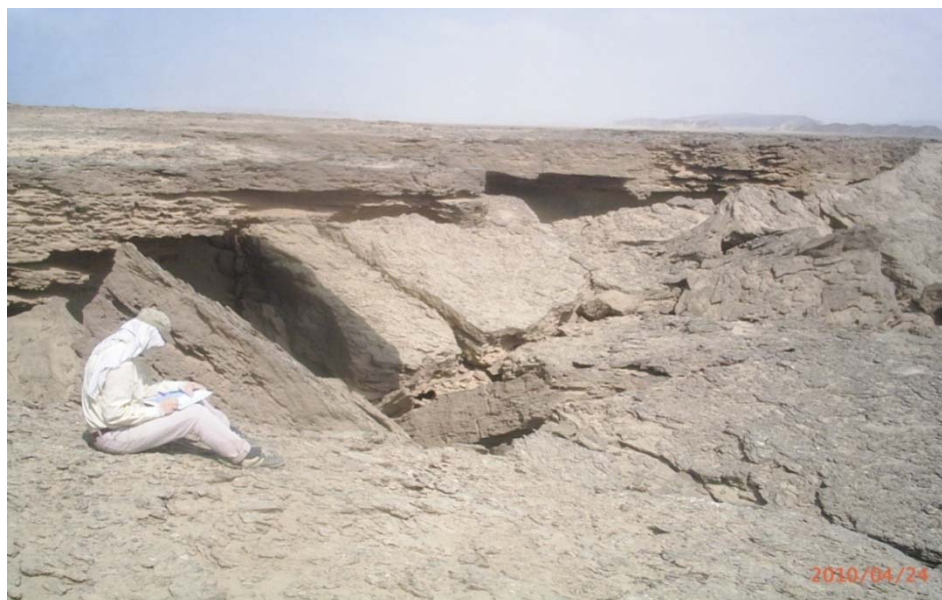
شکل ۳-۳۱ ریزش لایه واحد Qmt بدلیل فرسایش لایه مارنی زیرین در محدوده لوماشل پشد غربی ۱ (نگاه به شمال تا شمال شرق)
