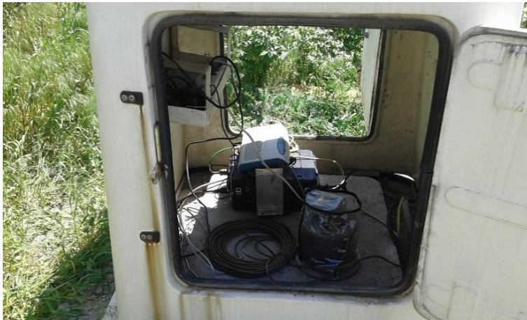
شکل ۳-۵ نمونه‌ای از تجهیزات ارتباطی اینترنتی در ایستگاه دانشگاه شهید رجایی
