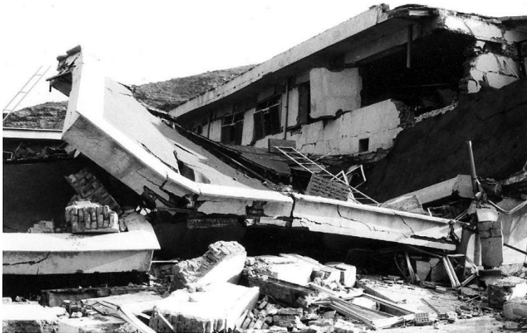
شکل ۲۱-۳ فروریختن طره‌های بزرگ در ساختمان بیمارستان رودبار (عکس از مهندس نادرزاده)
