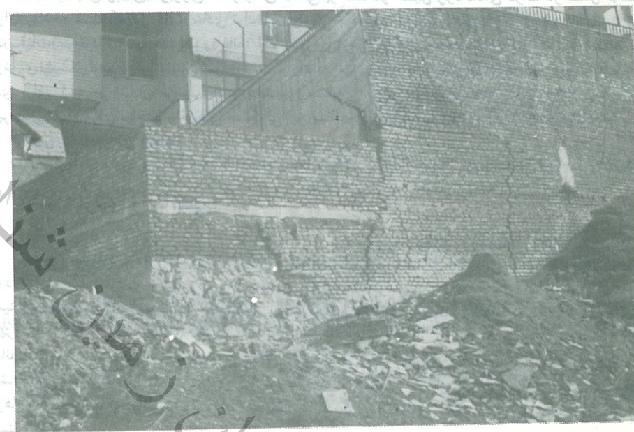
نگاره‌ی ۱۰۱۰- نگرشی نزدیکتر به نگاره‌ی ۱۰۹ و نشان دادن گسترش و نوترکها و شکافهای شاغولی، مورب و نشست‌ی در دیواره‌ها و پی‌ساختمان بنا شده بر روی خاک دستی مسیل قدیمی رودخانه‌ی درکه در شمال یوسف‌آباد تهران (نگاه بسوی شمال، ۱۳۶۲ خورشیدی).
