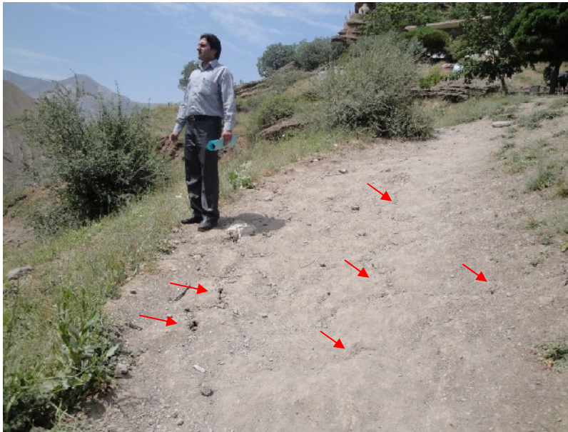
شکل ۳: وجود ترک‌های کششی در دامنه و مسیر منتهی به امامزاده. (دید به سوی جنوب باختری).
