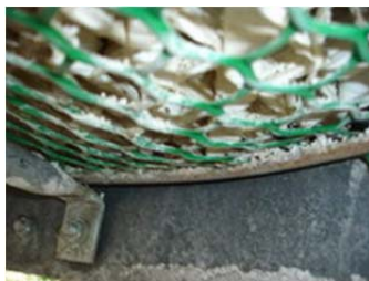
رسوب در قسمت معیان برج خنک‌کن
