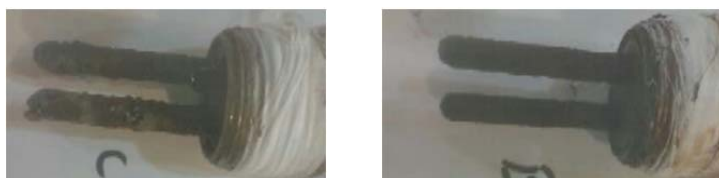
شکل ۳-۹: الکتروود خوردگی در مسیر بسته و در حال چرخش پکیج (تصویر سمت راست)، برج خنک کن (تصویر سمت چپ)،
