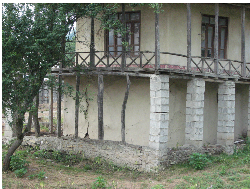
تصویر ۶- کج شدگی ستون‌های بلوکی جدیدی که جایگزین ستون‌های چوبی قدیمی شده‌اند. این مسأله دلالت بر تداوم حرکت و ادامه فعالیت توده لغزشی دارد.
