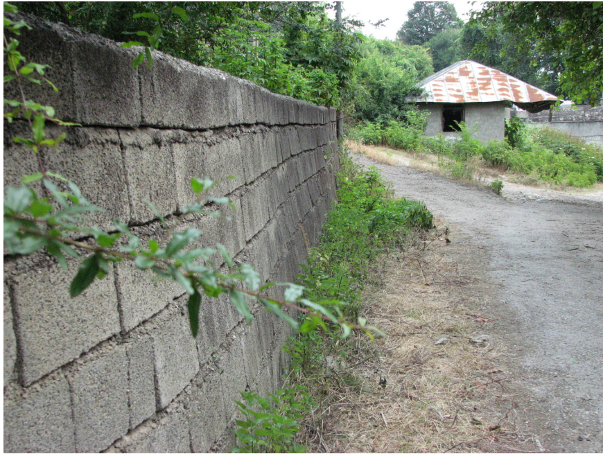
تصویر ۳- کج شدگی دیوار بلوکی
