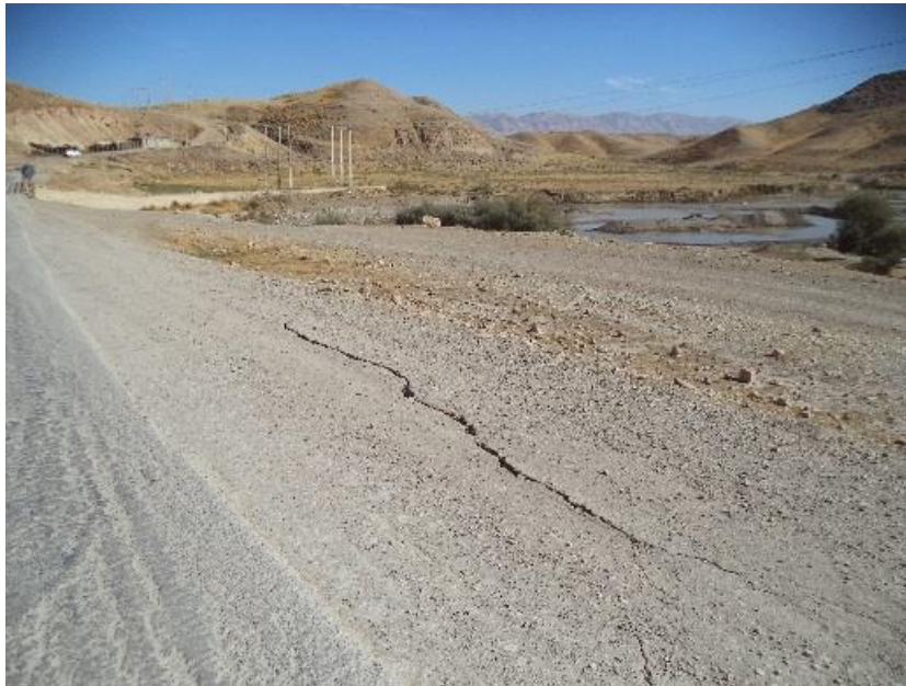
شکل 8 خرابی ترک طولی در لبه راه در محور سرپل ذهاب به ازگله [13]
