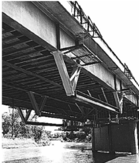
شکل الف-۵۰- میراگر روزنه متغیر نصب شده بر روی پل ایتر استیت در اکلاهاما
