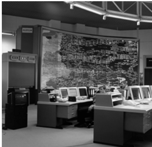
شکل (۴-۲) نمایی از یک مرکز دیسپاچینگ
