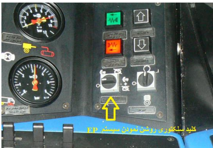
شکل ۴-۱۲۴) کلید سلکتوری روشن نمودن سیستم EP لکوموتیو زیمنس
