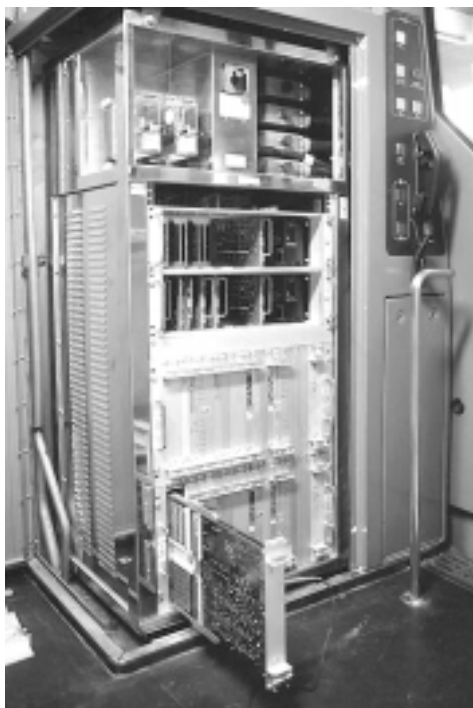
شکل ۸-۱- تجهیزات ATC داخل کابین
