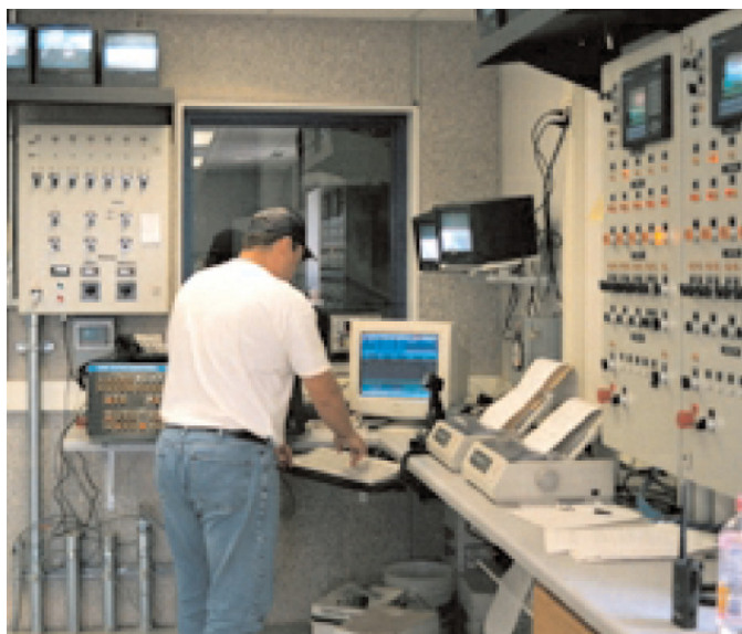
شکل ۸-۱ اتاق کنترل برای تجهیزات توزین عملیات بچینگ در یک واحد تولید بتن آماده
