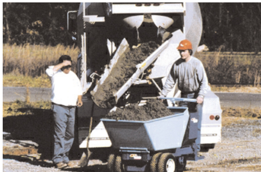
شکل ۸-۱۰ فرغون موتوری می‌تواند با انعطاف زیاد انواع بتن را از کامیون بتن آماده در فواصل کوتاه حمل نماید
