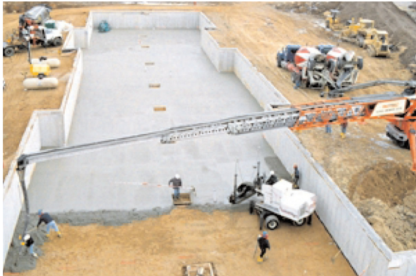
شکل ۸-۱۵ تسمه نقاله یک روش بسیار موثر و روش قابل‌حملی برای کار با بتن و بتن‌ریزی است. یک شوت پرتابی از جدایش بتن به محض تخلیه از تسمه نقاله جلوگیری کرده و یک جداکننده جلوی از دست رفتن ملات را می‌گیرد.
