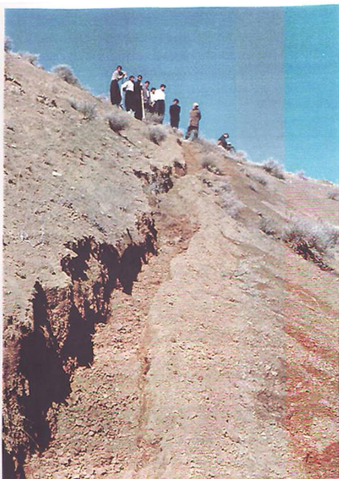
عکس شماره ۱۸ - حفر ترانشه در مارن‌های سازند آغاچاری شمال روستای بردبیل، نگاه به شمال
