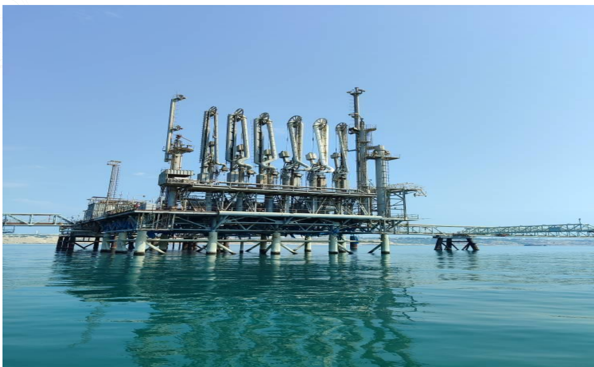
شکل ۵- تأسیسات اسکله بارگیری نفت در پایانه آذرباد
