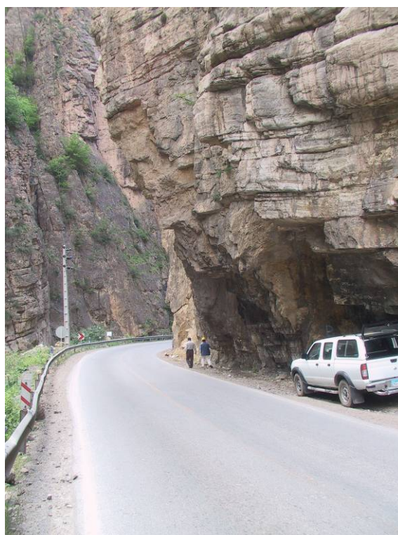
عکس شماره ۴-۱۶- نمای عمومی دامنه سنگ دولومیتی (S22). دامنه مذکور دارای پتانسیل احتمال رخداد ناپایداری‌های صفحه‌ای و سقوط وزنی می‌باشد که آزاد شدن بلوکهای سنگی بزرگ و سقوط آنها در مسیر جاده می‌تواند بسیار خطر آفرین باشد.
