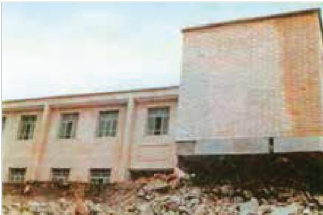
شکل ۱-۷ ساختمان دبستان روستای ناوه پس از زلزله سال ۱۳۷۵ از معدود بناهای باقیمانده در روستا [۱۰]
