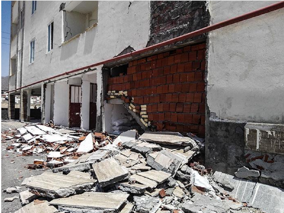
شکل ۲-۳ ریزش دیوار به علت عدم مهار به سازه اصلی
