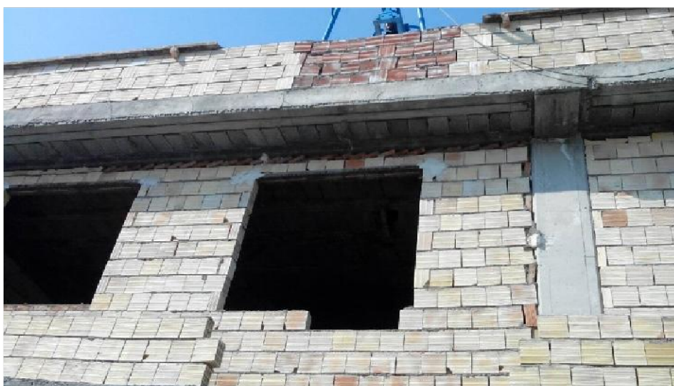
شکل ۲-۶ عدم استفاده از نعل درگاه
