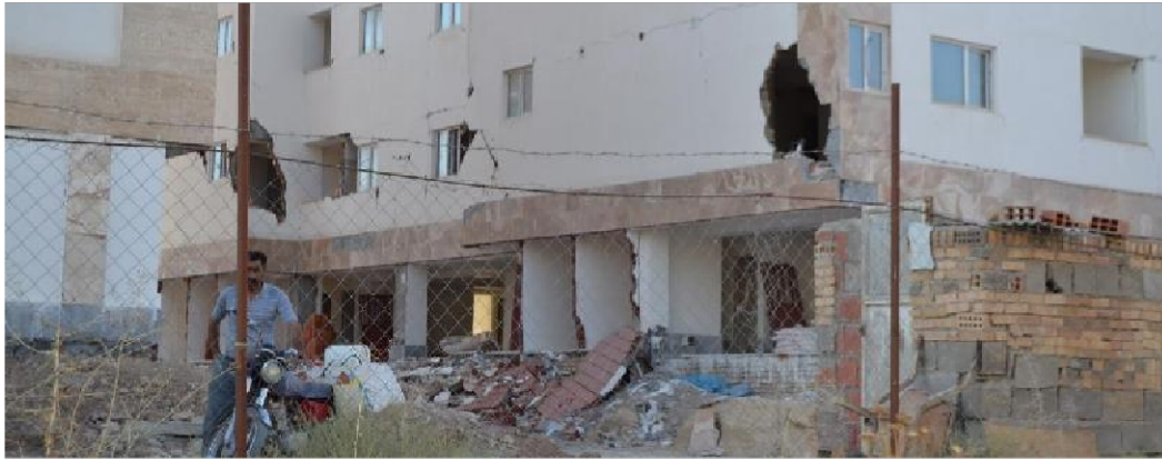
شکل ۱-۱۱ خرابی اتفاق افتاده در گلستان شهر بجنورد (شدت خرابی بیشتر از روستای ناوه می باشد).
