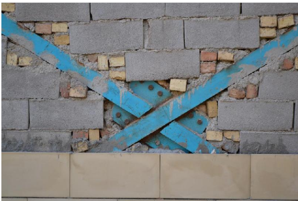
شکل ۲-۴ دیوارچینی نامناسب و استفاده از ملات ناکافی (کمبود ضخامت بند)
