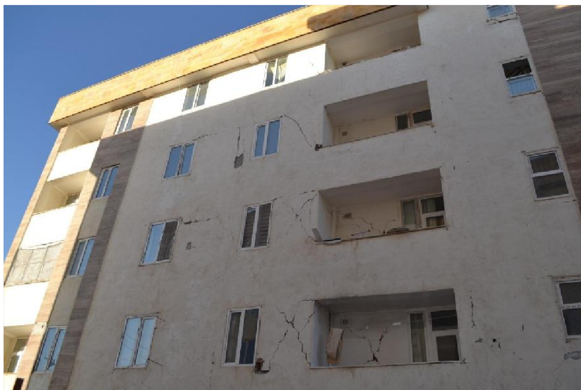
شکل ۲-۷ وجود بازشوهای متعدد و عدم تقویت بازشوها با وال پست
