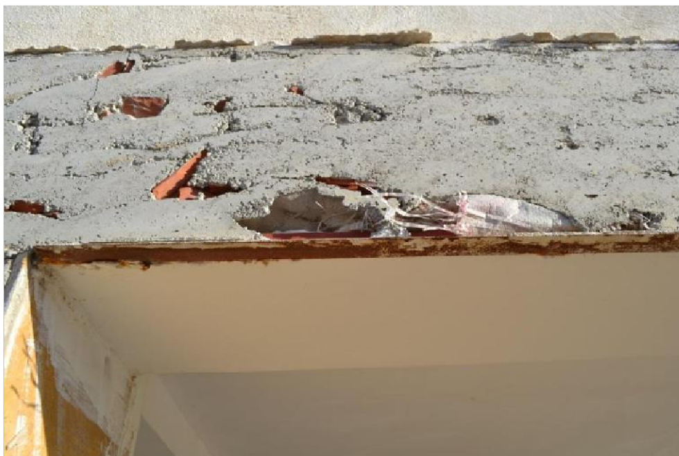
شکل ۲-۸ استفاده از ملات نامناسب پشت نما
