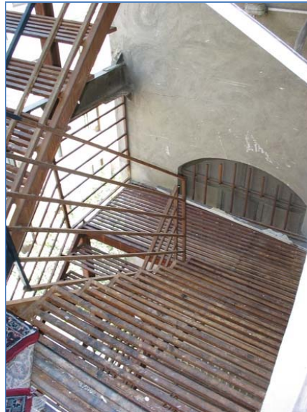
شکل پ-۴ راه‌پله خروج غیر مجاز با کف مشبک و وجود پنجره در قفسه راه‌پله
