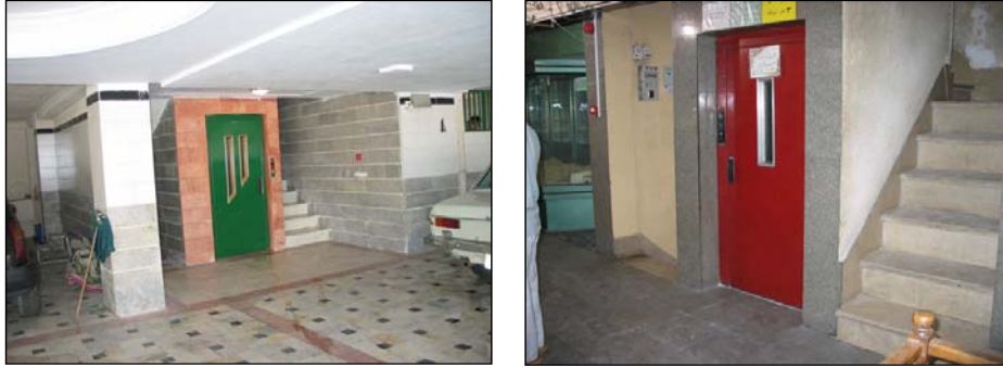
شکل پ-۳- راه پله خروج بدون دوربندی و دارای ارتباط غیر مجاز با آسانسور
