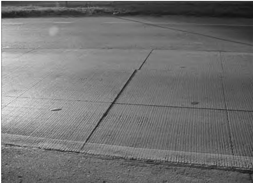
شکل ۱۸-۹: خرابی روکش‌های بتنی فوق نازک در اثر لغزش پانل‌ها (عکس از نویسنده)
