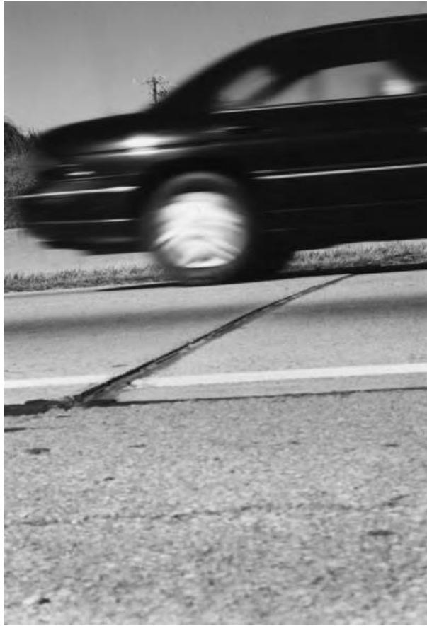
شکل ۳-۱۰: ترک عرضی پلکانی شده (عکس از نویسنده)
