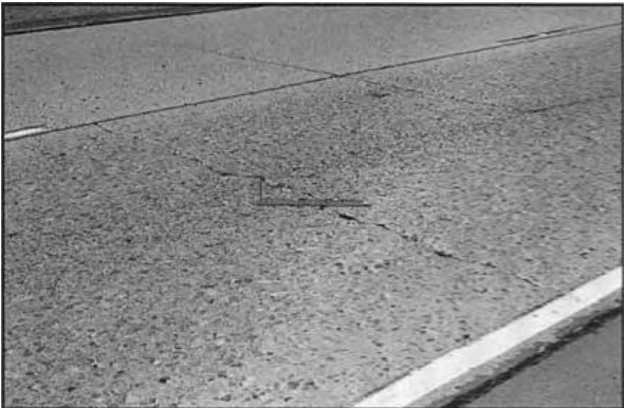
شکل ۳-۴: ترک‌های عرضی با شدت زیاد در JRPC (Miller & Bellinger, 2003: 41)
