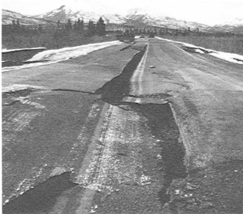
شکل ۱-۶ تخریب مسیر به علت تاثیر زلزله
