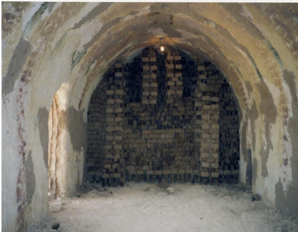
شکل ۲-۱۲ کوره تونلی هوفمن برای پخت آجر، واحد بنیاد بتن
