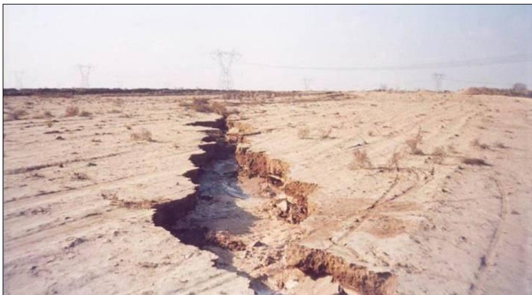
شکل ۳-۴۸- شکاف ایجاد شده ناشی از نشست زمین در جنوب روستای معین آباد، ورامین، ۱۳۸۳
