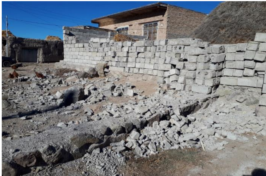
شکل ۶۲-۲ ریزش دیوارهای برخی از محوطه‌ها در اثر زلزله
