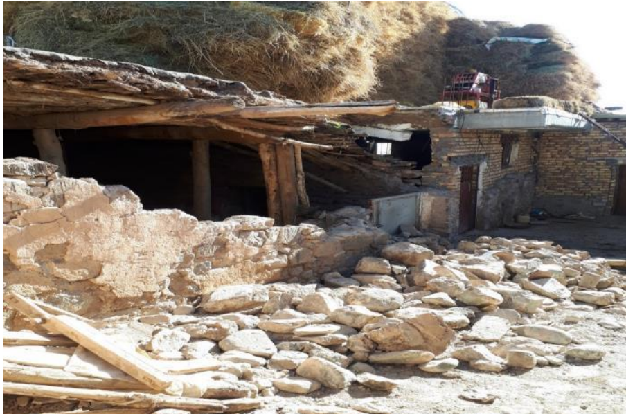
شکل ۲-۳۷ تخریب دیوار به دلیل ضعف مصالح و عدم اتصال مناسب با سقف
