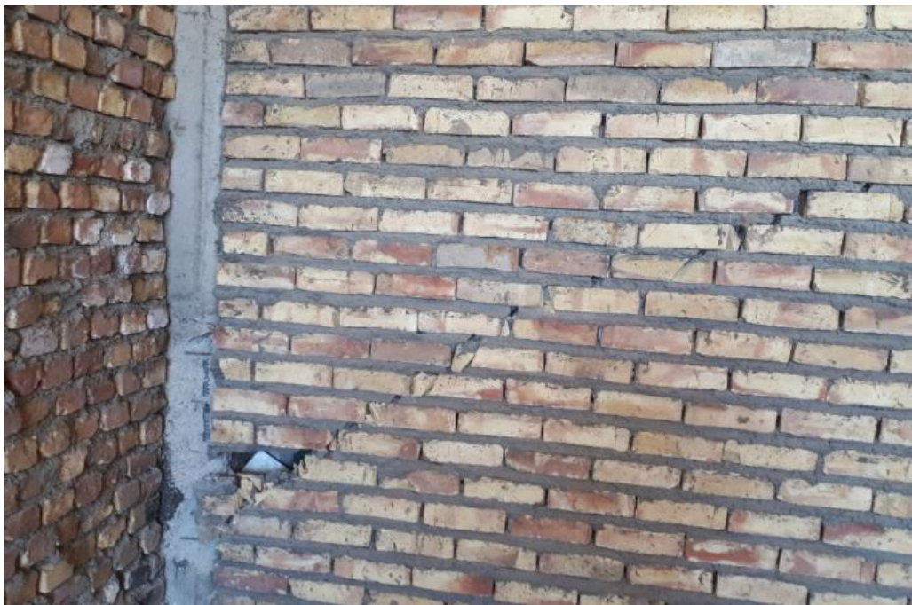
شکل ۴۴-۲ بروز ترک برشی در دیوار و تخریب پوشش بتن در ستون‌های مجاور
