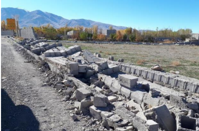
شکل ۲-۸۰ تخریب تعدادی از دیوارهای محوطه‌ها در روستای اسب فروشان
