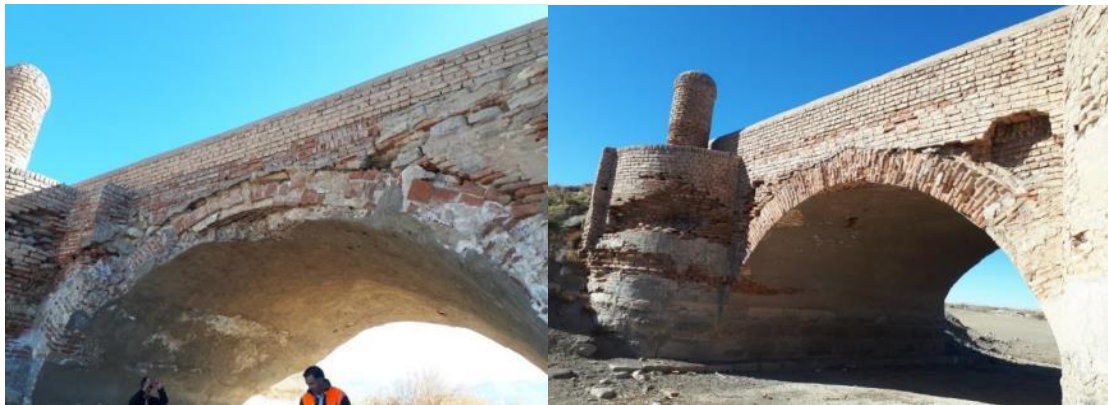
شکل ۲-۸۷ آسیب به پل تاریخی در منطقه اسبفروشان سراب
