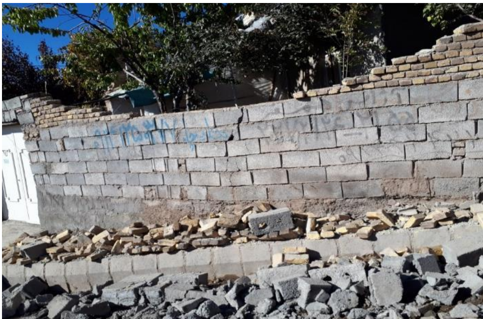
شکل ۱۰-۲ آسیب‌دیدگی و تخریب دیوار حیاط منازل
