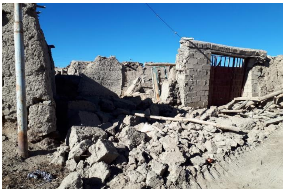
شکل ۵۵-۲ نمونه ای از تخریب‌های ساختمان‌های خشتی و گلی روستای تیرشاب
