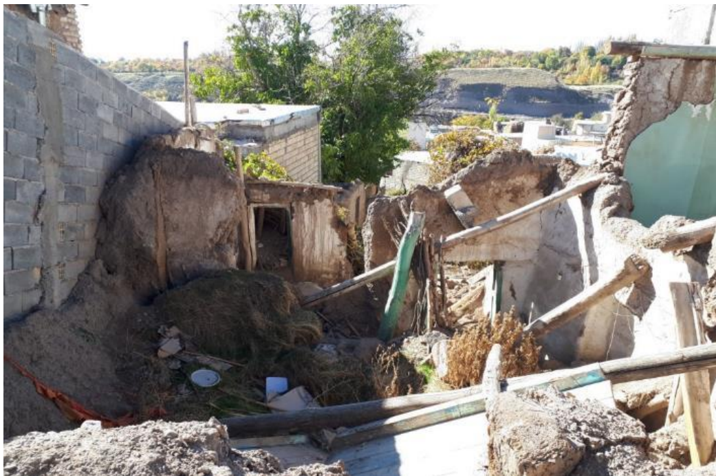
شکل ۲-۱۳ بروز تخریب (سقوط سقف) در اثر سنگینی سقف و فاصله زیاد تیرهای چوبی
