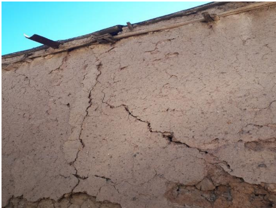
شکل ۲-۳۳ شکست برشی در دیوار سازه مصالح بنایی و ناپایداری کل ساختمان
