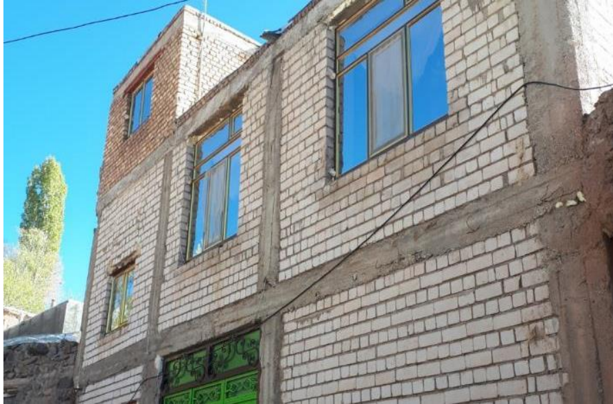
شکل ۲-۴۷ عملکرد لرزه ای مناسب سازه های دارای اسکلت و آسیب دیدگی بسیار جزئی
