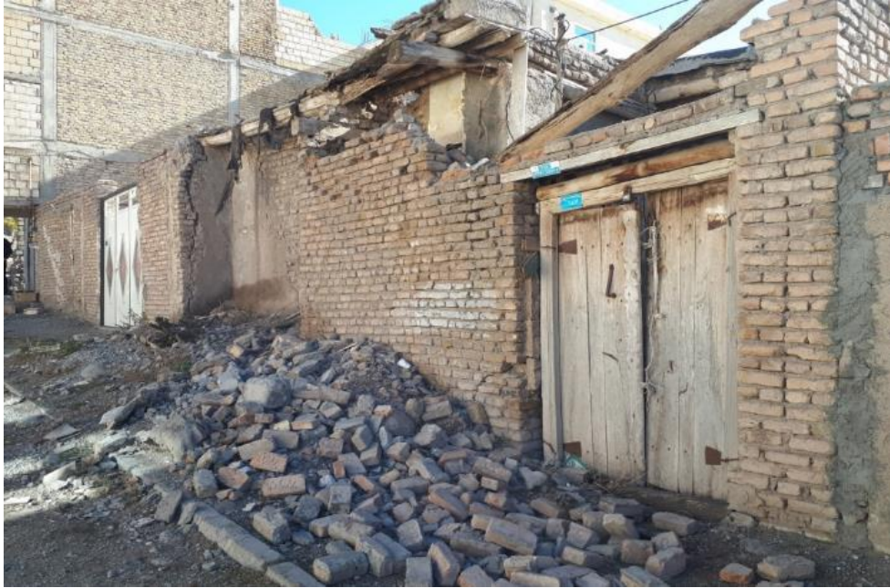
شکل ۱۱-۲ ریزش دیوار حیاط منازل در اثر حرکت جانبی و عدم وجود عناصر نگهدارنده جانبی
