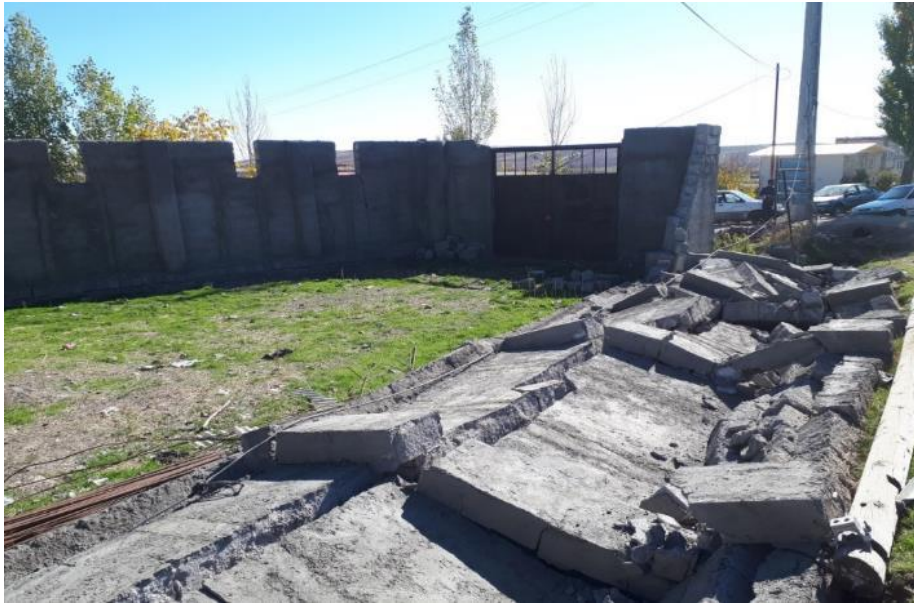
شکل ۲-۲۶ تخریب و واژگونی دیوار (ضربه زدن به تیرهای برق و مخابرات)
