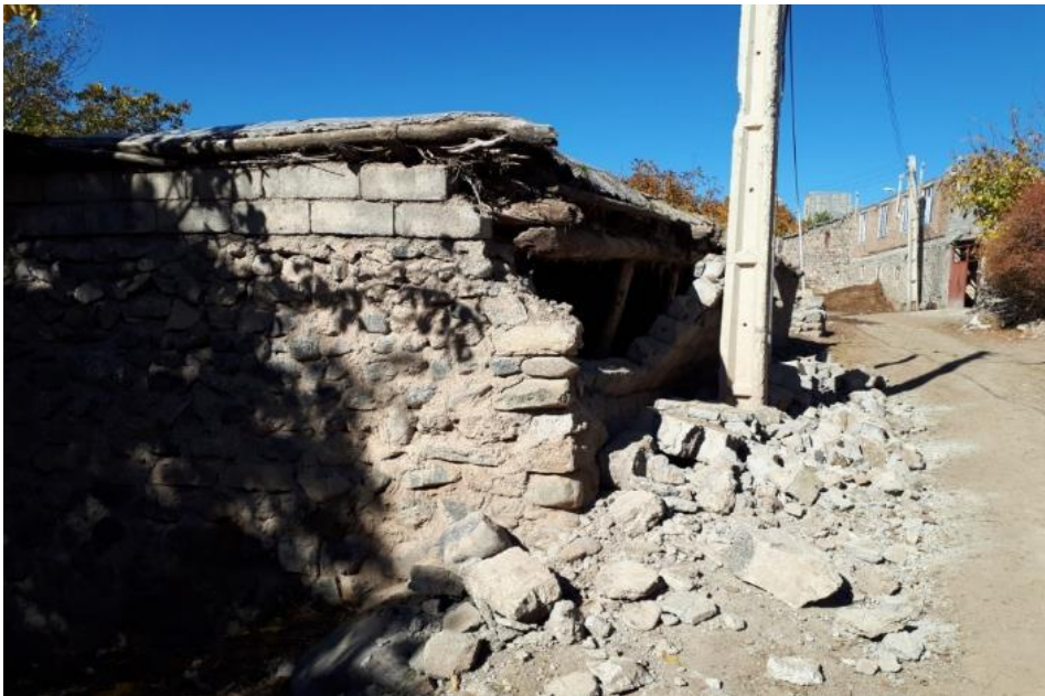
شکل ۹-۲ واژگونی و تخریب کامل دیوارهای موازی تیرریزی در اثر عدم وجود اتصال کافی با سقف و عدم وجود بار ثقلی سقف
