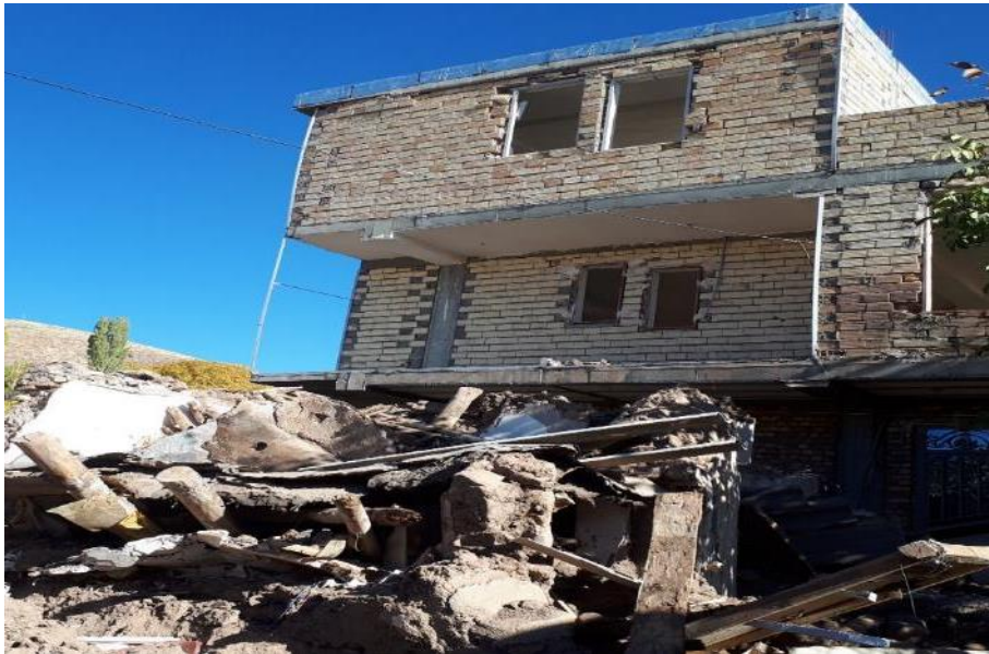
شکل ۲-۴۸ مقایسه رفتار لرزه ای سازه بنایی ضعیف و سازه دارای اسکلت در ورنکش
