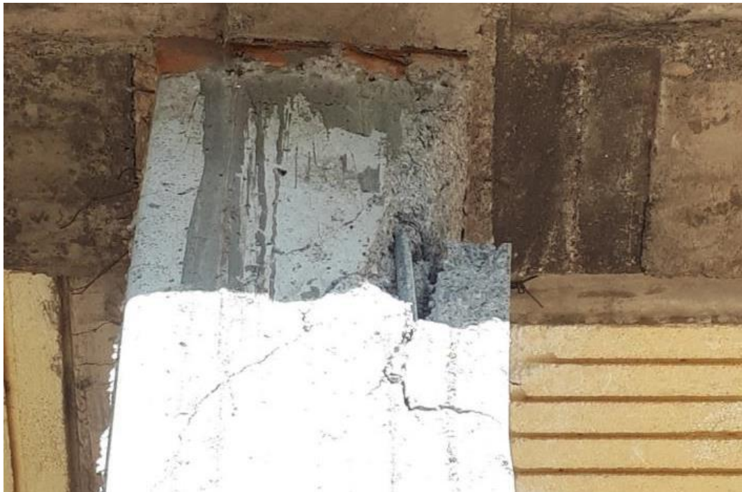
شکل ۲-۴۶ آسیب در پوشش ستون در ساختمان اسکلت بتنی به دلیل ضعف اجرایی
