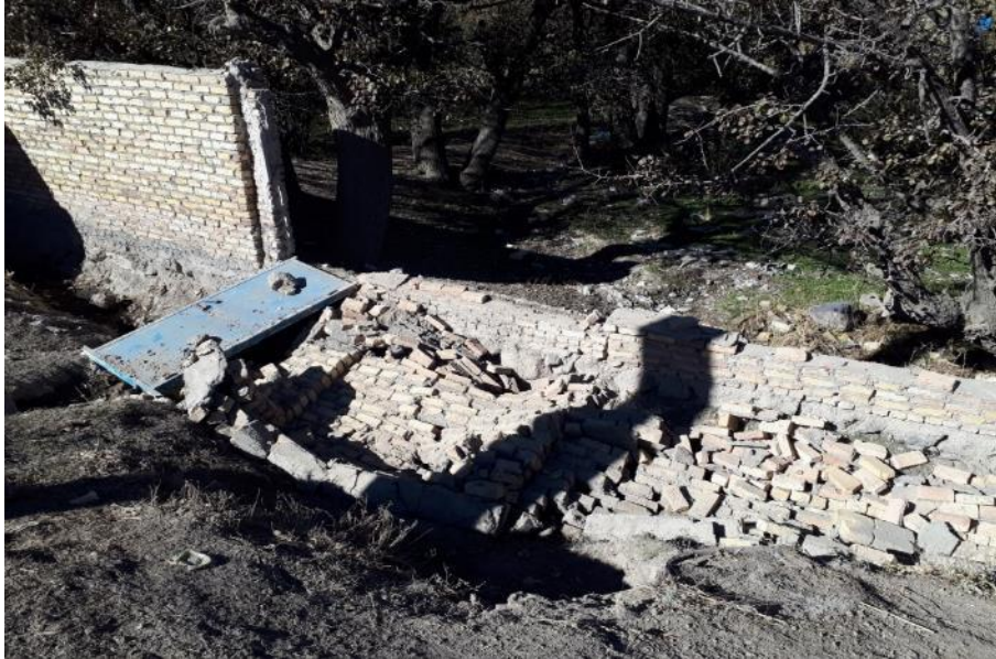
شکل ۲-۶۷ ریزش دیوار محوطه‌ها به دلیل عدم وجود پشت بند و درز اجرایی در این دیوارها
