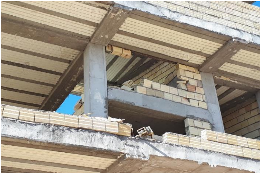
شکل ۲-۵۲ ریزش مصالح دیوارها در زلزله در ساختمان اسکلت بتنی (عدم وجود مهار و اتصال مناسب)
