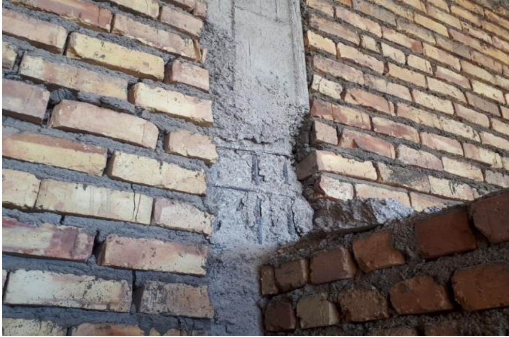
شکل ۲-۴۵ بروز تخریب در پوشش بتن ستون در ساختمان اسکلت بتنی دو طبقه
