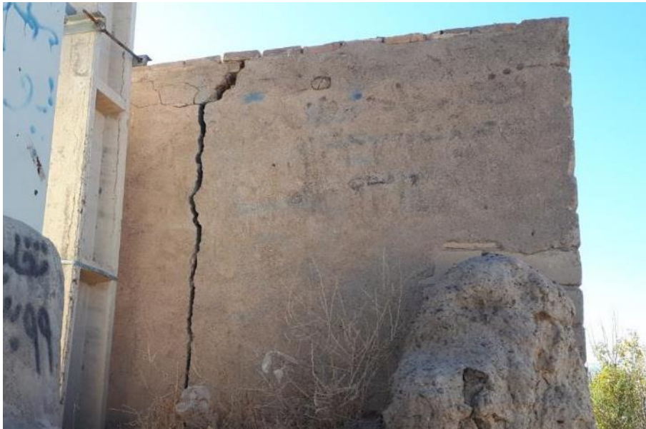
شکل ۲-۶۹ بروز ترک قائم در دیوار بنای آجری در روستای دونیق
