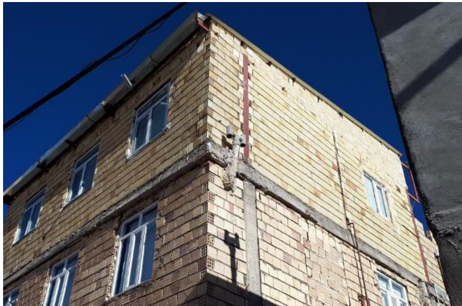
شکل ۲-۲۱ بروز ترک و ریزش مصالح دیوار در طبقه فوقانی ساختمان
