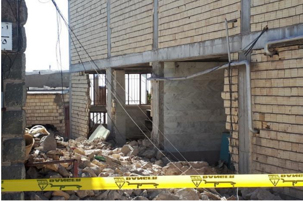
شکل ۲-۵۱ ریزش مصالح دیوارهای سازه دارای اسکلت در ورنکش (عدم وجود مهار و اتصال مناسب)
