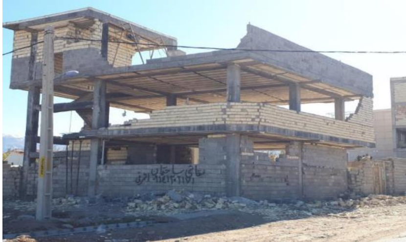
شکل ۸۲-۲ ریزش دیوار ساختمان در اسب فروشان در اثر عدم رعایت ضوابط اتصال
