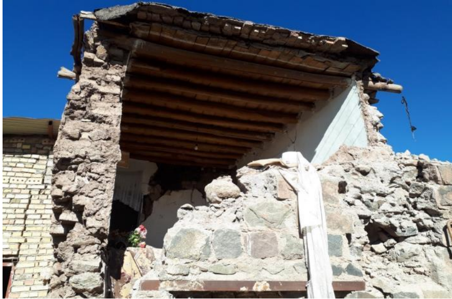
شکل ۲-۳۶ تخریب دیوار موازی تیرریزی سقف به دلیل عدم اتصال مناسب با سقف
