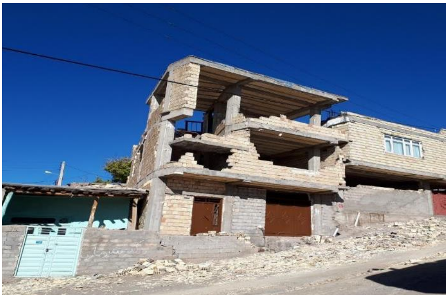
شکل ۲-۱۵ ریزش مصالح دیوار ساختمان اسکلت بتنی در روستای بالسین
