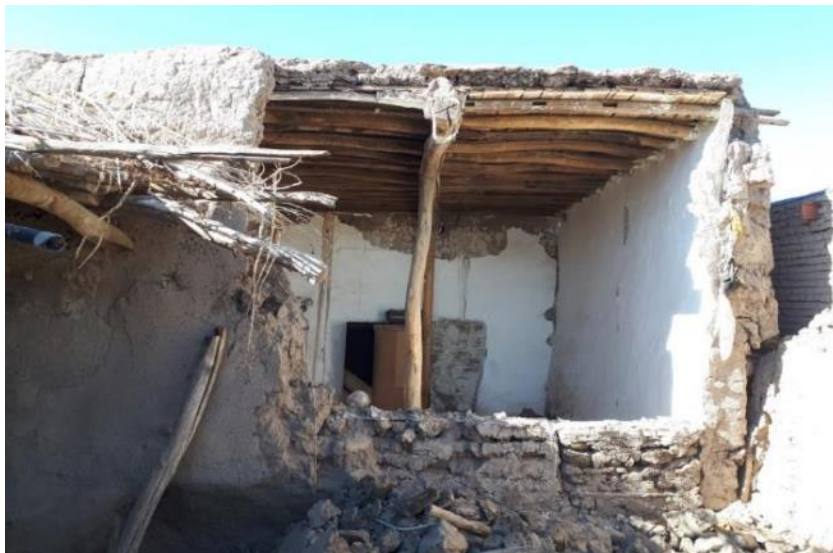
شکل ۷۲-۲ ریزش و واژگونی دیوار موازی تیرریزی سقف در سازه مصالح بتایی بدون کلاف
