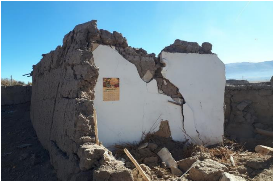
شکل ۲-۵۸ سقوط سقف سنگین در سازه خشتی و گلی
