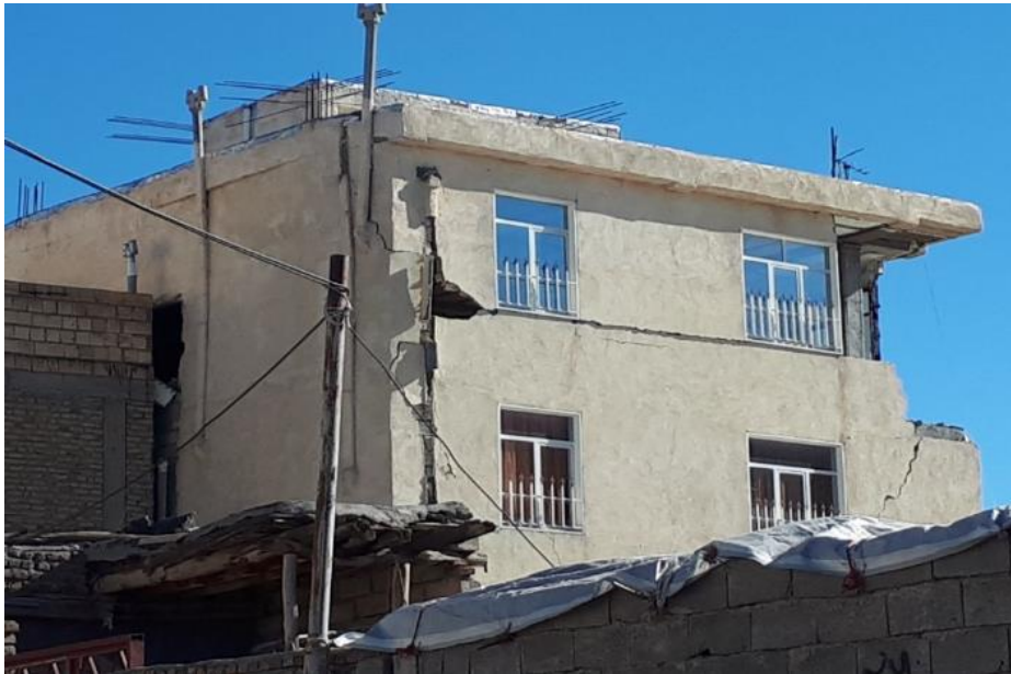
شکل ۲-۲۰ بروز تخریب در گوشه و محل تقاطع دیوارهای متعامد در محل اجرای دیوار خارج از قاب
