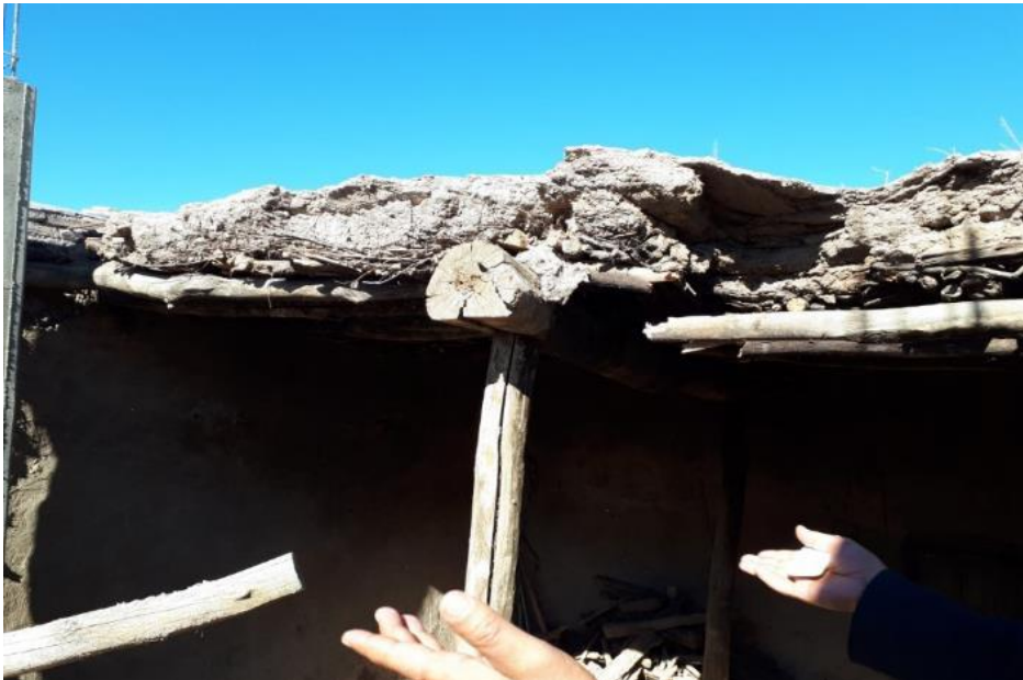
شکل ۲-۷۵ ضخامت زیاد سقف و عدم انسجام سازه بنایی بدون کلاف
