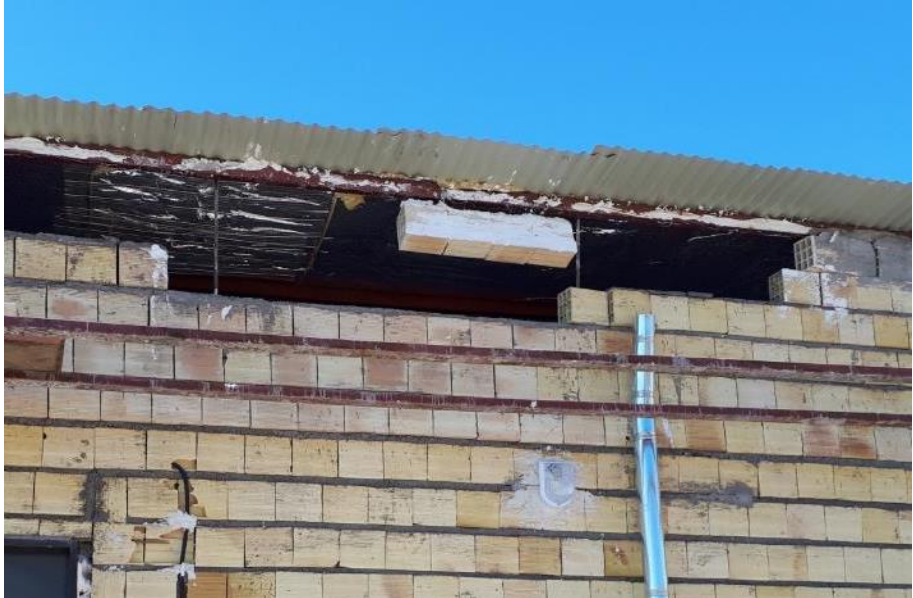
ادامه شکل ۲-۲۱ بروز ترک و ریزش مصالح دیوار در طبقه فوقانی ساختمان
