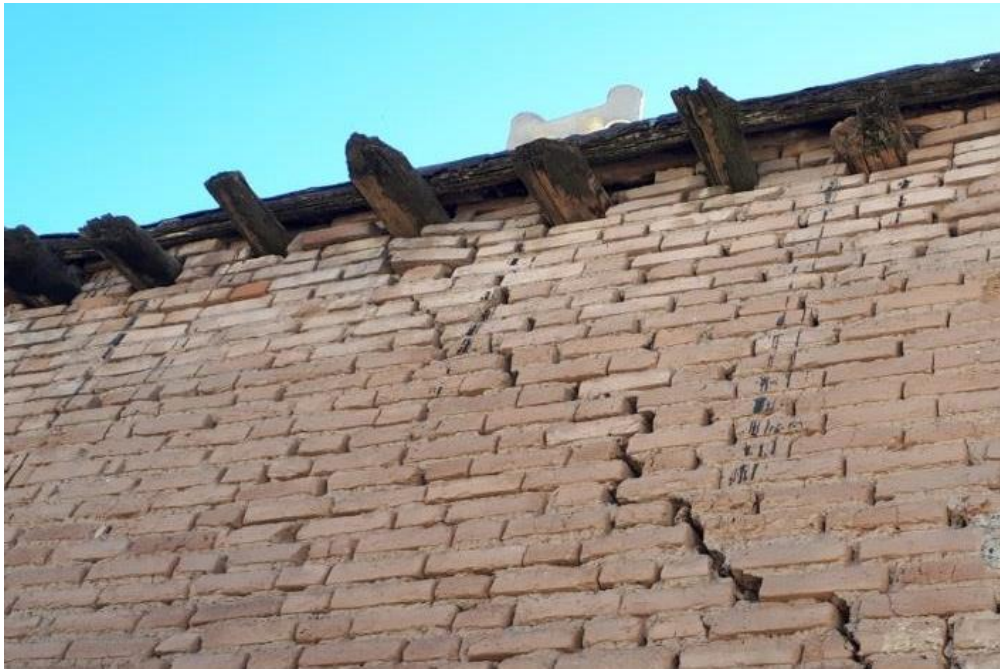
شکل ۲-۶ بروز گسیختگی پلکانی در دیوار ساختمان مصالح بنایی
