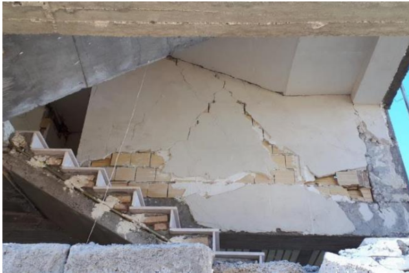
شکل ۸۳-۲ تخریب دیوارهای ساختمان اسکلت بتنی در اسب فروشان
