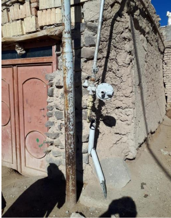
شکل ۲-۳ شکست علمک گاز در اثر تخریب دیوار مجاور در زلزله
