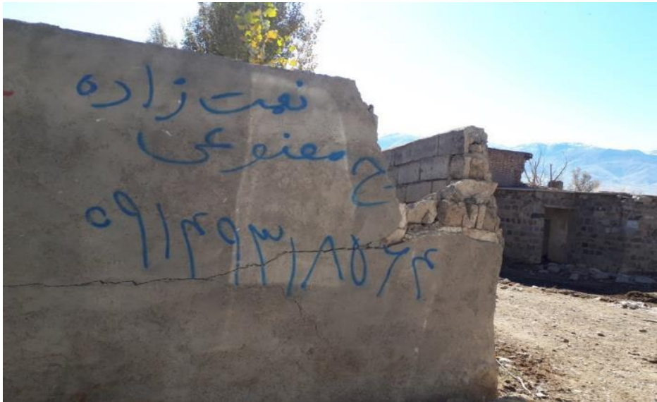
شکل ۲-۷۴ تخریب و واژگونی برخی دیوارهای بنایی محوطه‌ها در هروان
