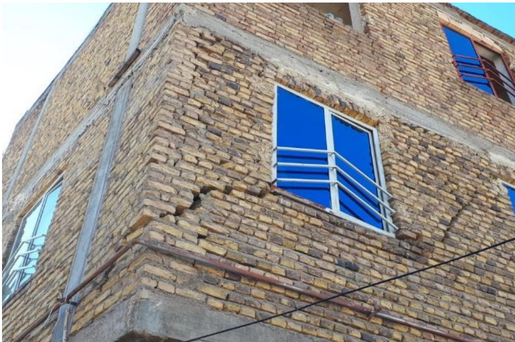
شکل ۱۹-۲ بروز تخریب و تضعیف شدید دیوار پیرامونی
