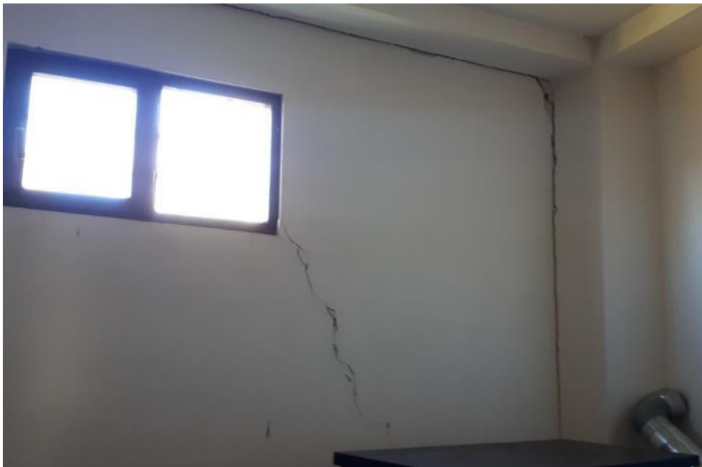
شکل ۲-۲۲ آسیب‌های اندک در ساختمان‌های دارای اسکلت در منطقه بالسین
