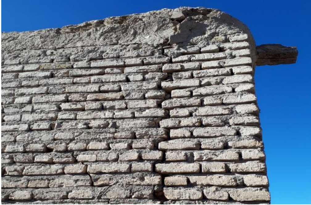
شکل ۲-۵۷ نمونه‌ای از بروز جداشدگی در دیوارهای متعامد (در اثر عدم اتصال مناسب بین دو دیوار)
