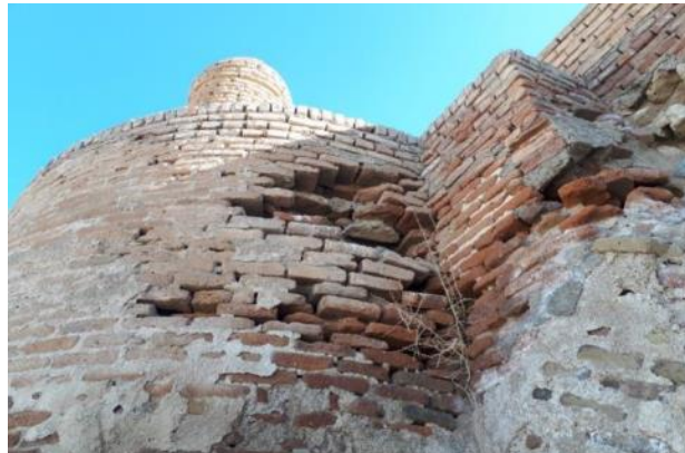
شکل ۲-۸۶ آسیب به پل تاریخی در منطقه اسبفروشان سراب
