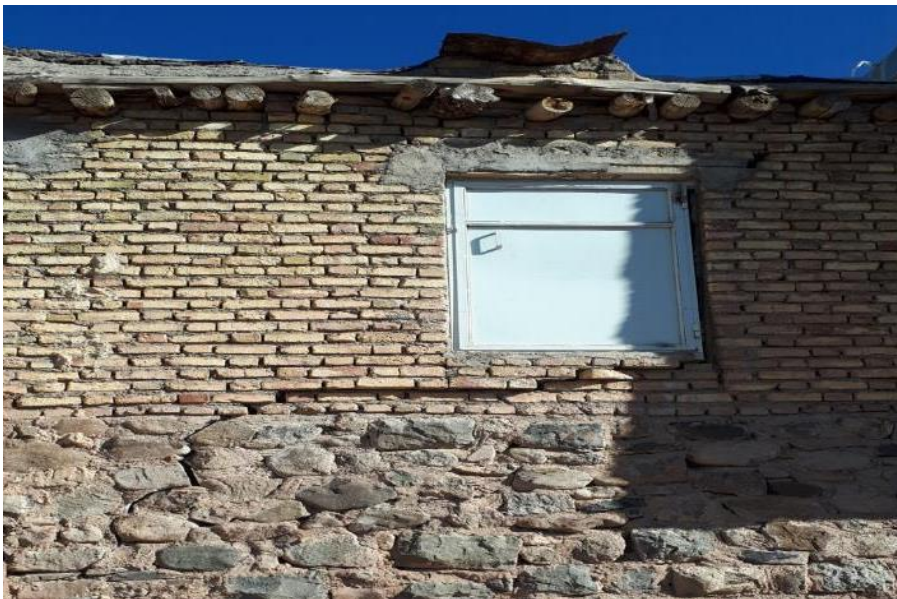
شکل ۲-۳۵ بروز ترک در دیوار سازه مصالح بنایی، بیرون زدگی دیوار و ناپایداری کل ساختمان در موارد متعدد در ورنکش
