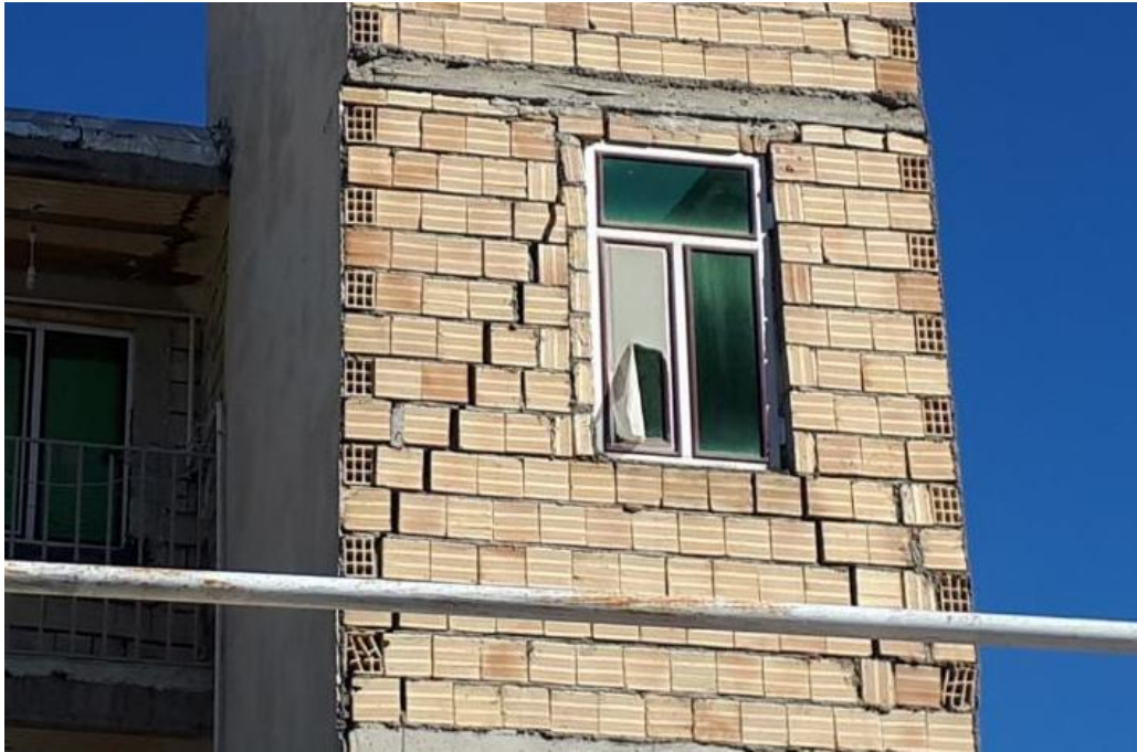
شکل ۱۸-۲ بروز تخریب و تضعیف شدید دیوار پیرامونی
