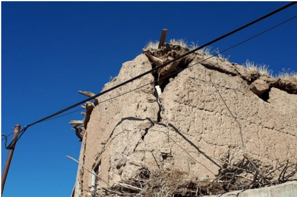
شکل ۱۲-۲ بروز تخریب گوشه در ساختمان‌های خشتی و سنگی
