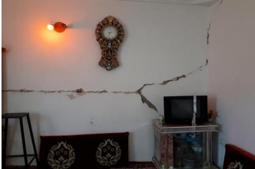
شکل ۷۱-۲ ترک خوردگی دیوارهای ساختمان سازه بتایی با کلاف افقی
