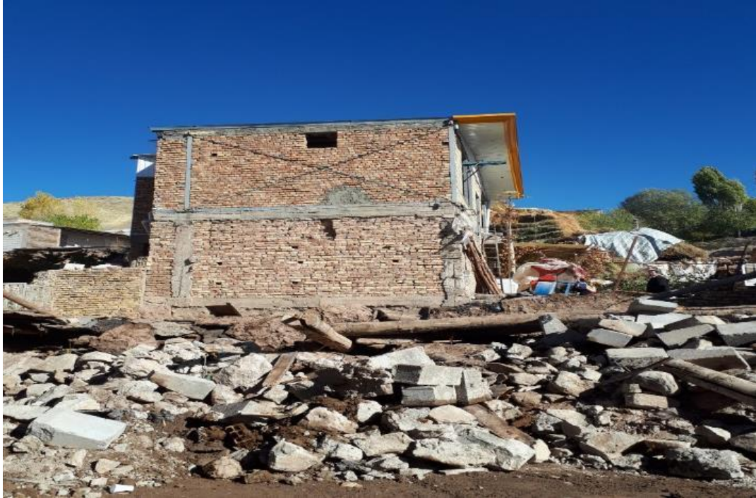
شکل ۲-۴۲ مقایسه رفتار لرزه‌ای سازه بنایی کلافدار (سازه کلافدار ترکیبی مغایر با ضوابط ۲۸۰۰) و بدون کلاف (تخریب کامل سازه بدون کلاف)
