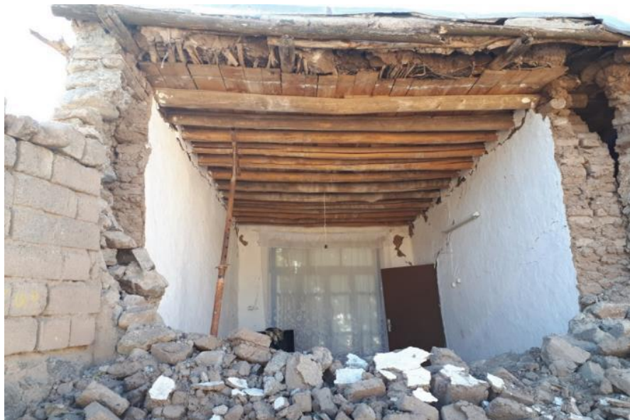
شکل ۲-۸ واژگونی و تخریب کامل دیوار در اثر عدم وجود اتصال کافی
