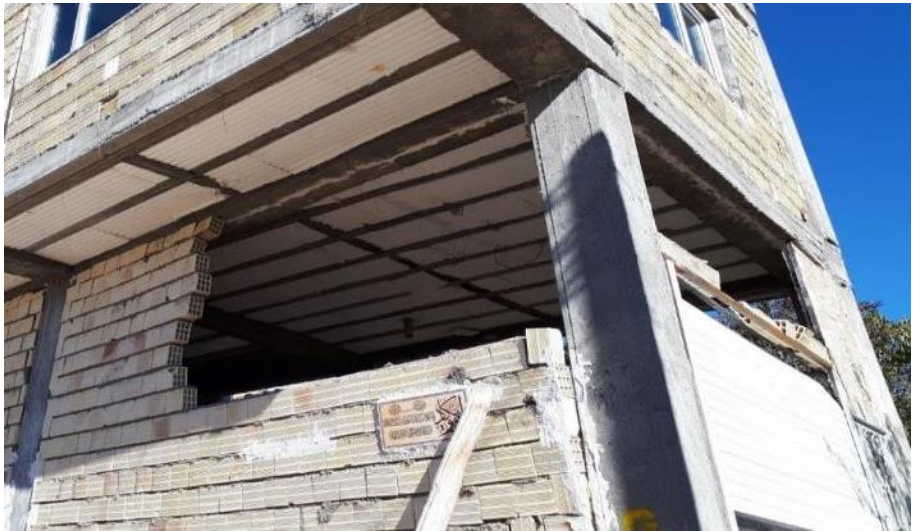
شکل ۲-۱۶ ریزش دیوارها در برخی از ساختمان‌های دارای اسکلت روستای بالسن
