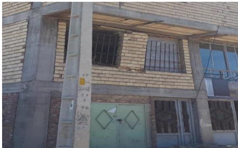
شکل ۲-۸۱ تخریب در دیوار حد فاصل دو بازشو، به دلیل عدم رعایت ابعاد و هندسه بازشوها
