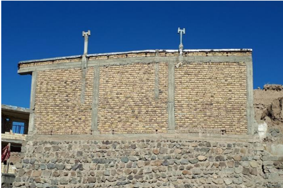
شکل ۲-۱۴ رفتار لرزه ای خوب و آسیب اندک ساختمان‌های کلاف دار در روستای بالسین
