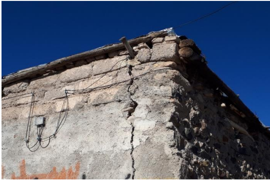
شکل ۲-۳۰ بروز گسیختگی بین دیوارهای متعامد در اثر حرکت جانبی دیوار و عدم اتصال کافی
