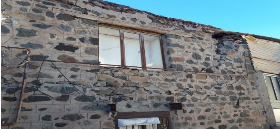
شکل ۲-۳۴ شکست برشی در دیوار سازه‌ای مصالح بنایی و تخریب سازه برابر ساختمان
