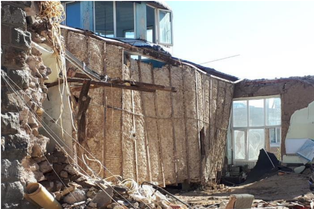
شکل ۲-۳۸ سقوط سقف طاق ضربی به دلیل تخریب دیوار تکیه گاهی
