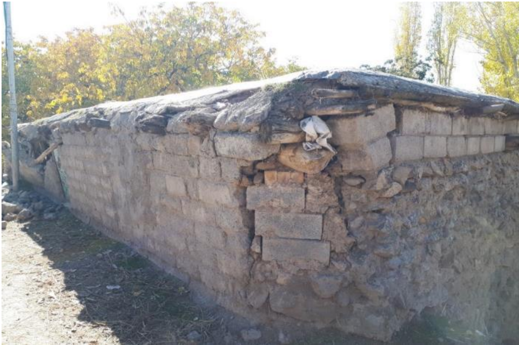
ادامه شکل ۲-۱۲ بروز تخریب گوشه در ساختمان‌های خشتی و سنگی
