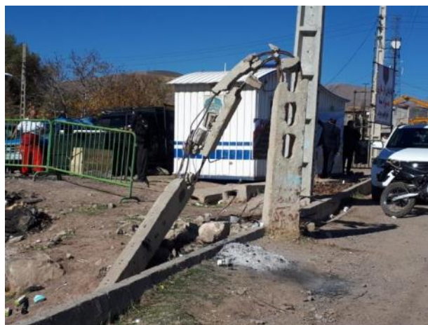
شکل ۴-۲ قطع تیر برق در منطقه زلزله زده
