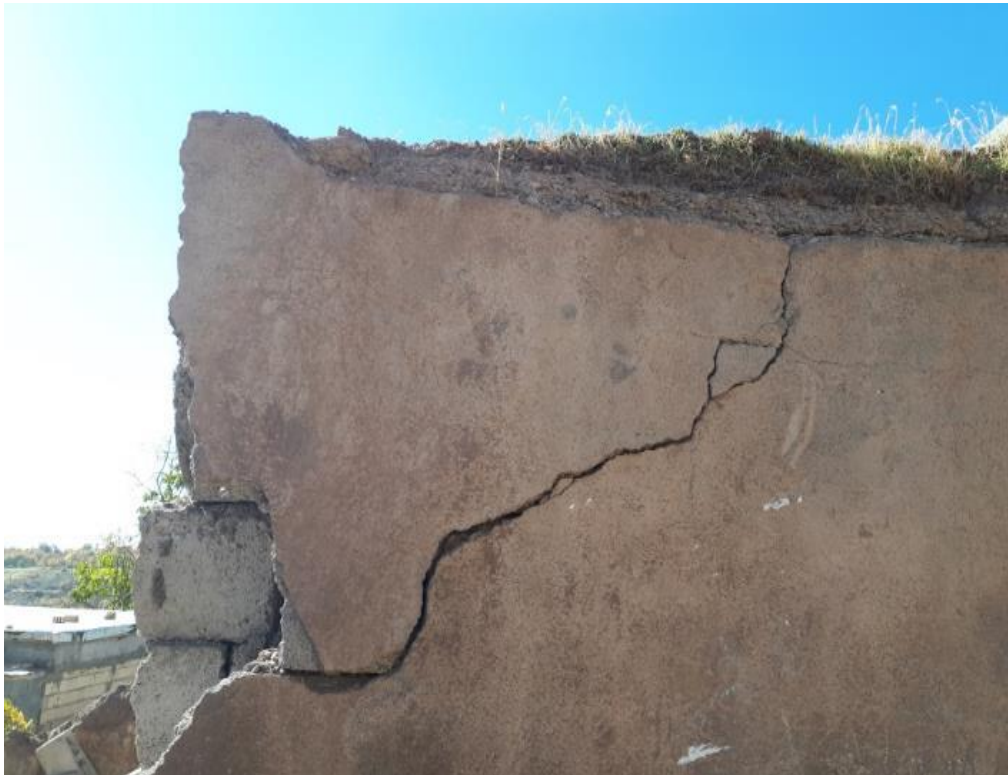
شکل ۲-۵ بروز ترک برشی در دیوار ساختمان مصالح بنایی
