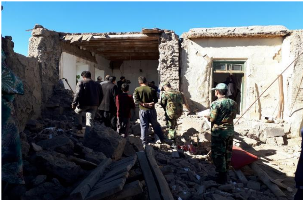
شکل ۲-۶۰ واژگونی دیوار موازی تیرریزی سقف
