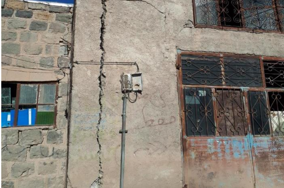
شکل ۲-۳۲ تخریب گوشه در محل تقاطع دیوارها در سازه بنایی قدیمی
