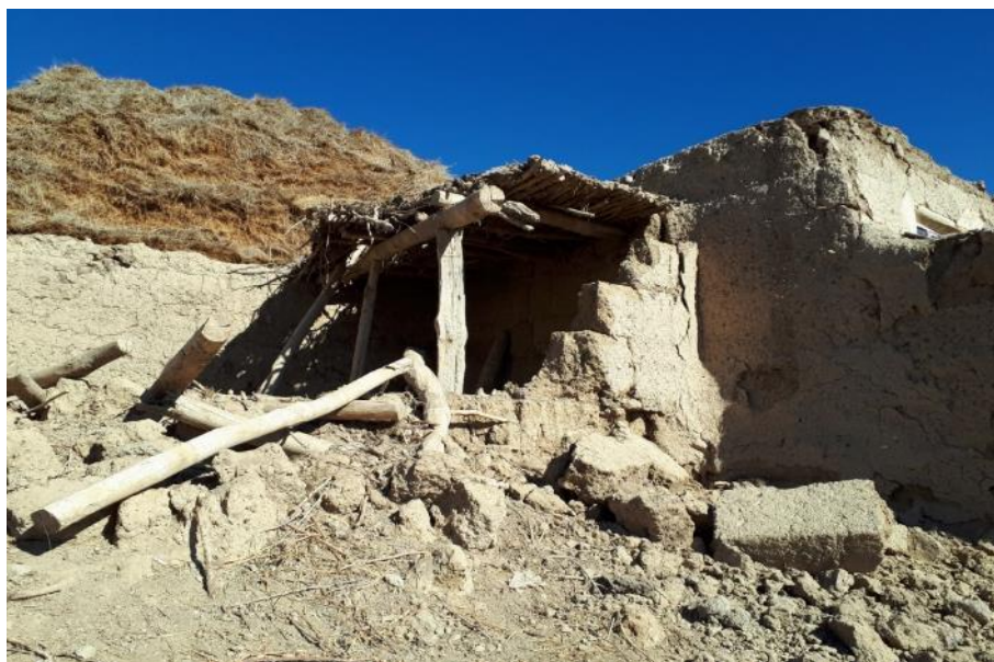
شکل ۵۶-۲ نمونه ای از تخریب‌های ساختمان‌های خشتی و گلی روستای تیرشاب (تخریب کامل)
