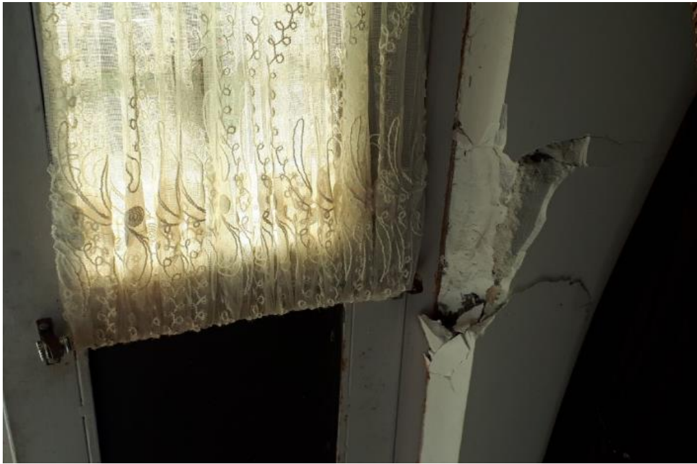
شکل ۲-۲۳ آسیب‌های اندک در ساختمان‌های دارای اسکلت در منطقه بالسین
