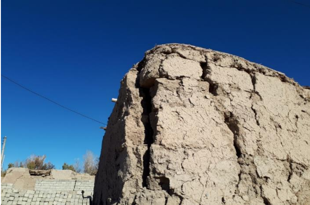
شکل ۲-۵۹ شکست گوشه در ساختمان گلی در روستای تیرشاپ
