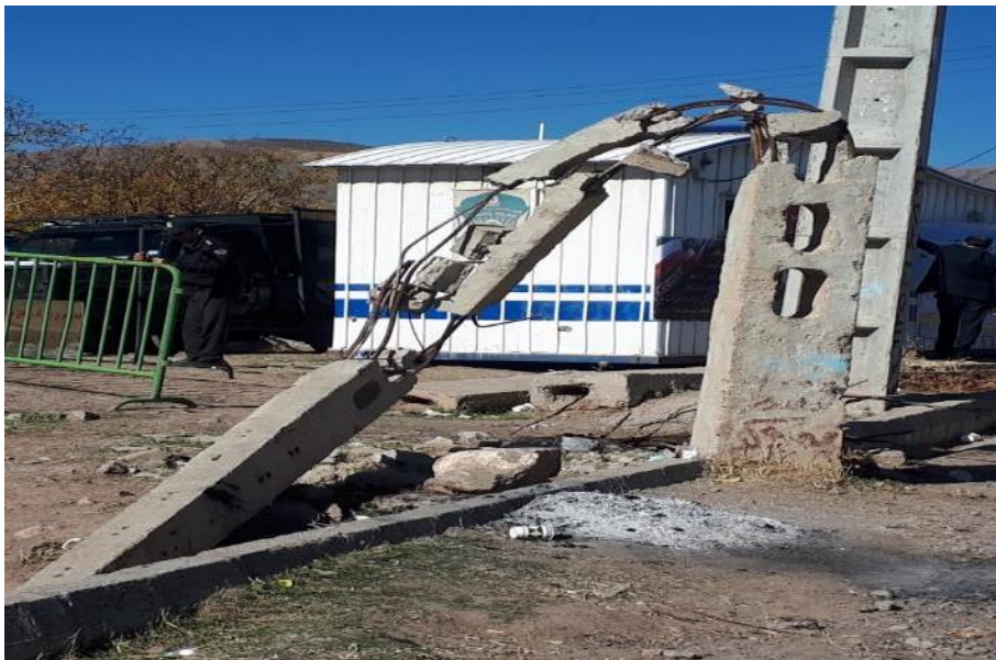
شکل ۲-۵۴ تخریب تیر برق در اثر زلزله در ورنکش
