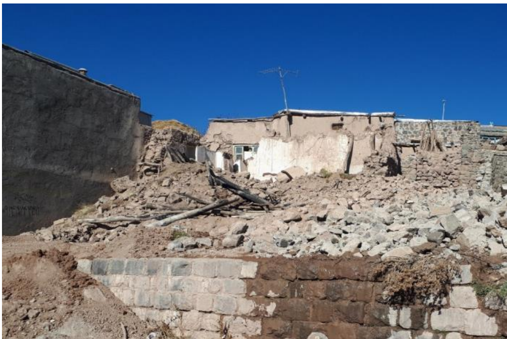
شکل ۲-۲۹ تخریب کامل سازه بنایی ضعیف (خشتی و سنگی) در ورنکش
