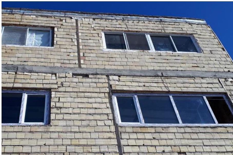
شکل ۲-۱۷ عدم ریزش مصالح دیوار در اثر استفاده از اتصالات و المان‌های نگهدارنده
