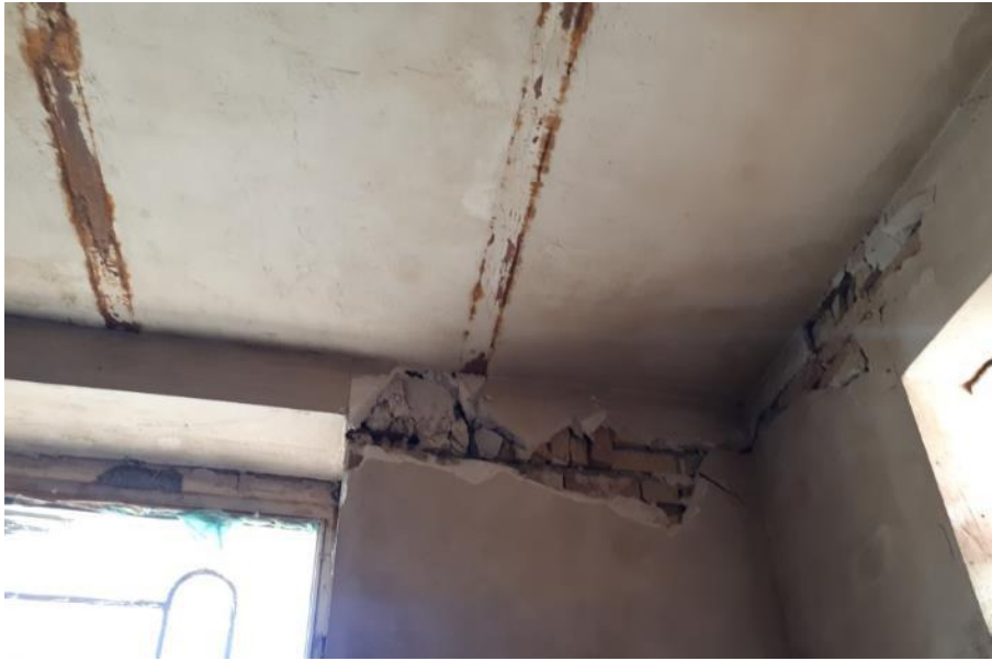
شکل ۲-۶۳ بروز ترک افقی در ساختمان بنایی آجری
