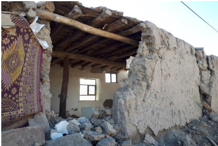
شکل ۲-۶۸ واژگونی و تخریب دیوار سازه مصالح بنایی ضعیف در روستای دونیق
