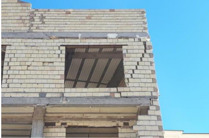
شکل ۲-۸۵ تخریب در گوشه، به دلیل عدم رعایت ابعاد بازشو و عدم اتصال صحیح دیوارها به اسکلت
