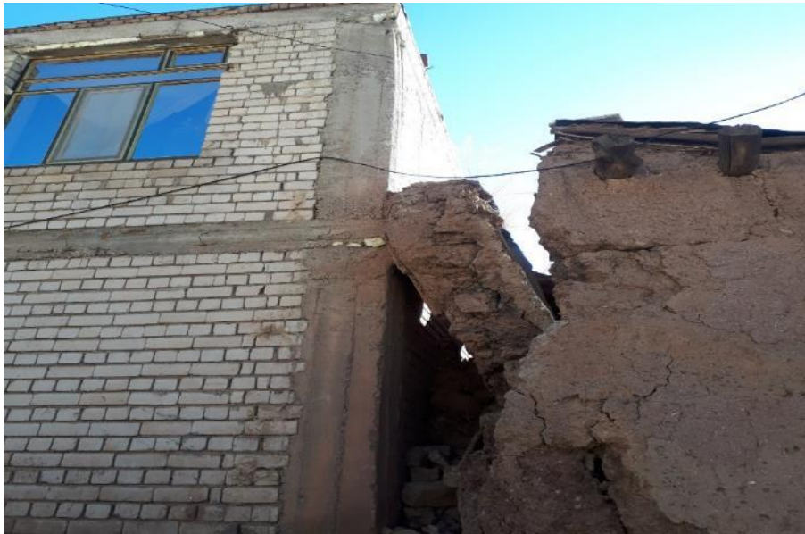
شکل ۲-۳۱ بروز تخریب بین دیوارهای متعامد در اثر حرکت جانبی دیوار و عدم اتصال کافی (ضربه زدن به ساختمان مجاور)
