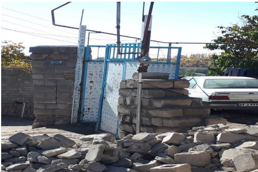
شکل ۲-۲۴ علمک آسیب دیده در منطقه بالسین بر اثر ریزش دیوار مجاور
