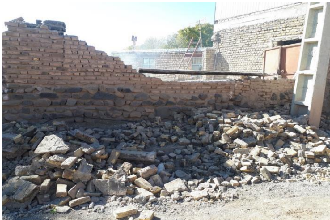
شکل ۲-۲۵ واژگونی و ریزش مصالح دیوار در روستای ورنکش
