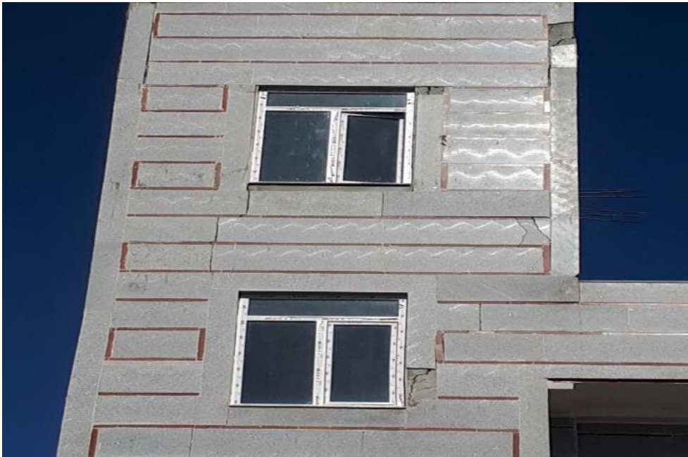
شکل ۲-۵۳ آسیب و ریزش مصالح نما در ساختمان اسکلت بتنی در ورنکش
