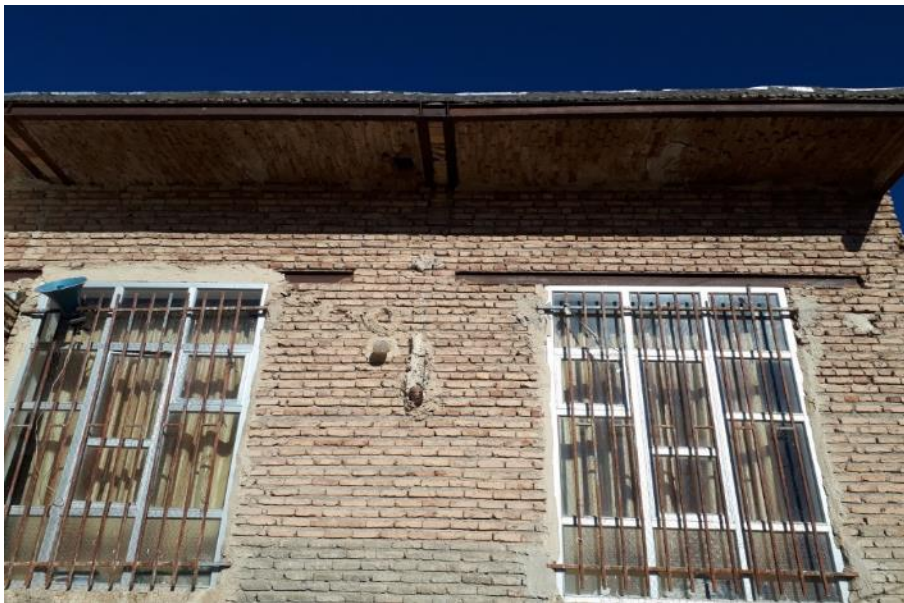
شکل ۲-۶۴ پایداری سازه مصالح بنایی آجری در روستای تیرشاب
