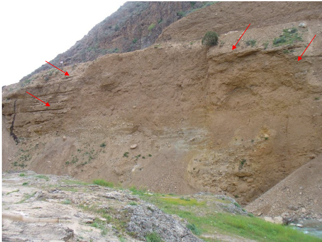
شکل ۱۴: لغزش ایجاد شده در دامنه خاکی بوسیله فرسایش رودخانه. (دید به سوی باختر)
