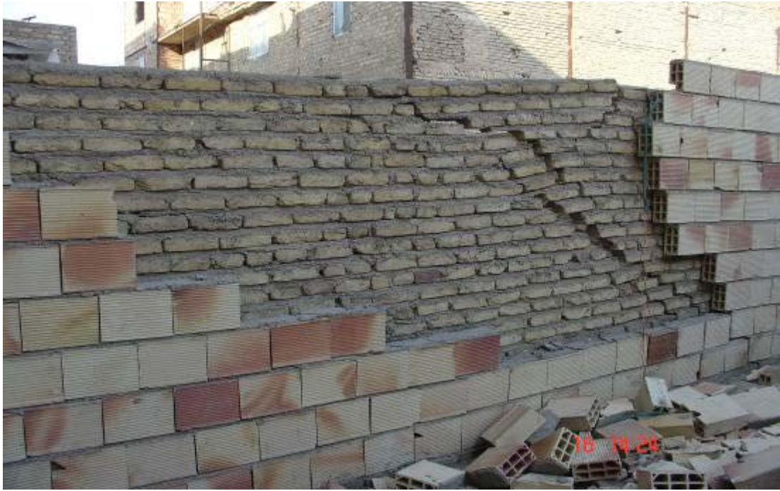
شکل ۷- نمونه ای از ریزش و شکاف های دیوار حیاط ساختمان
