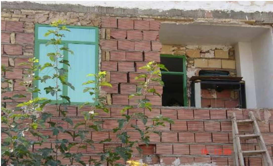
شکل ۴- ترک های موجود در دیوارها
