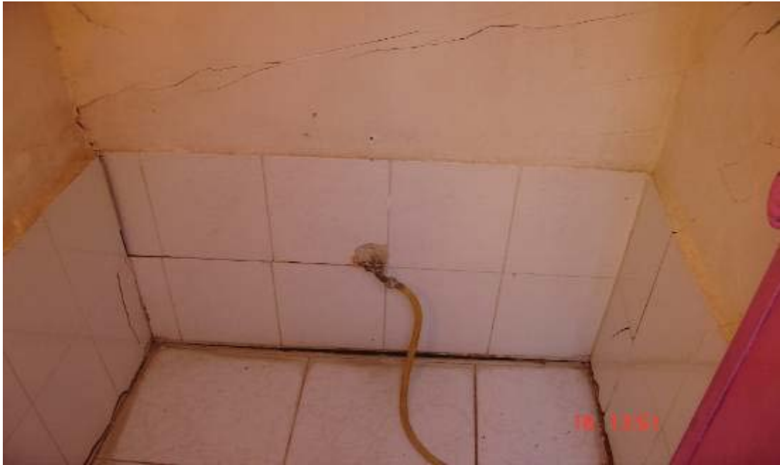
شکل ۵- جدا شدگی کف و گسترش شکاف در دیوار
