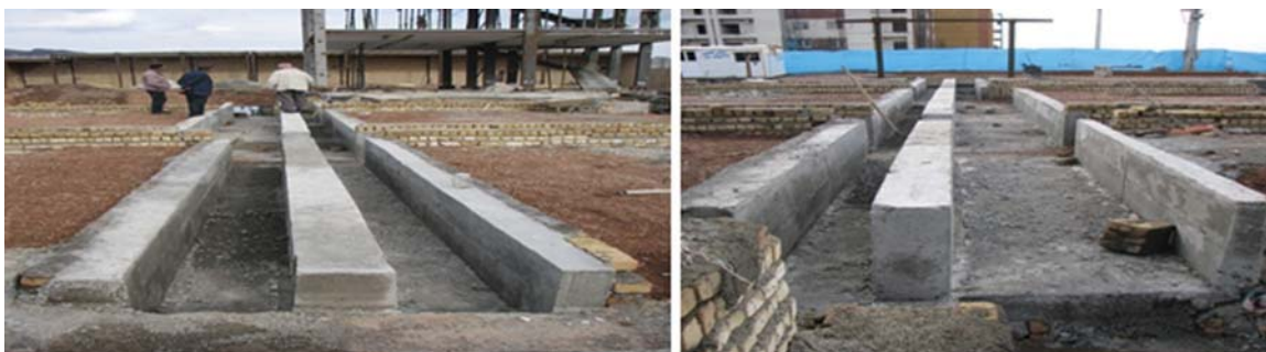
کانال عبور لوله های انتقال فرآورده و کابل های برق
