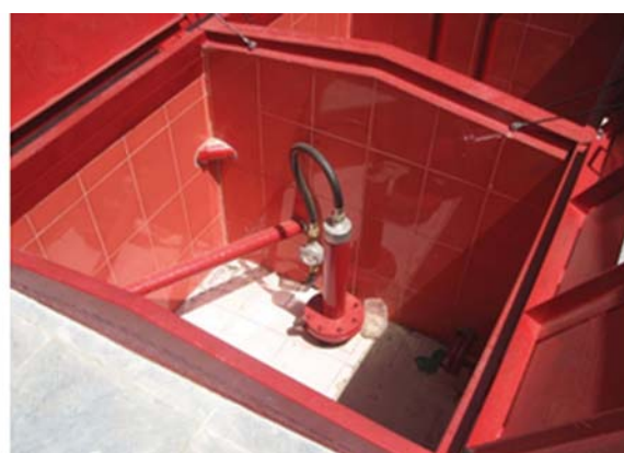
تجهیزات سیستم LG/TG نصب شده بر روی مخزن
