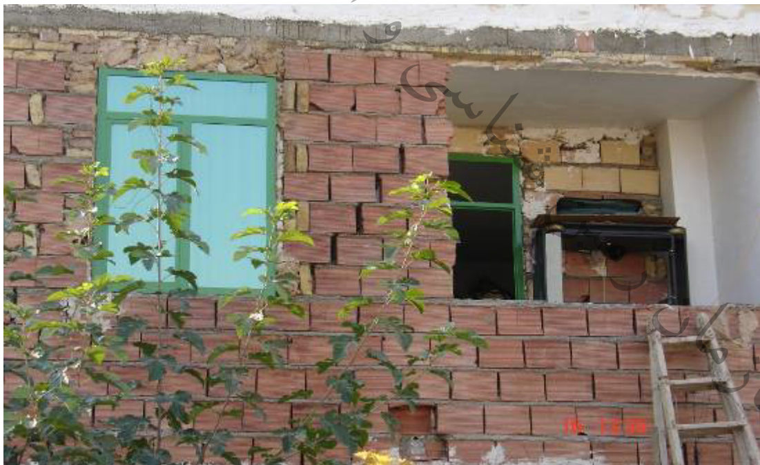
شکل ۴- ترک های موجود در دیوارها
