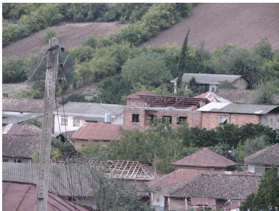
شکل ۲۲- تخریب شیروانی خانه‌ها بر اثر طوفان در آبادی جامخانه
