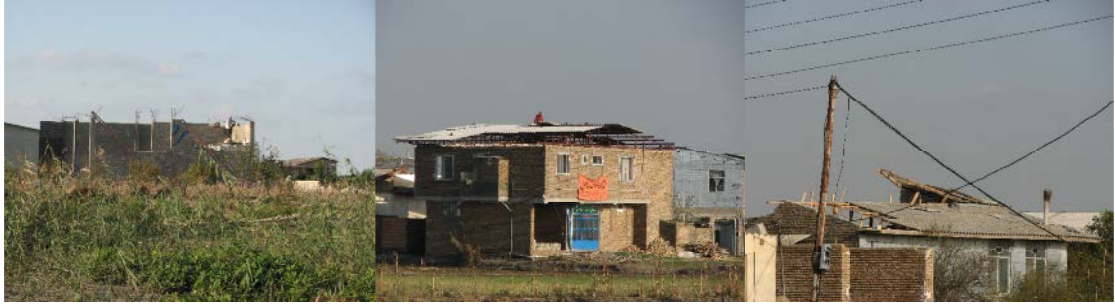
شکل ۴- تخریب شیروانی و سقف خانه‌ها بر اثر طوفان حدفاصل آبادی پنبه زار کتی- سید محله
