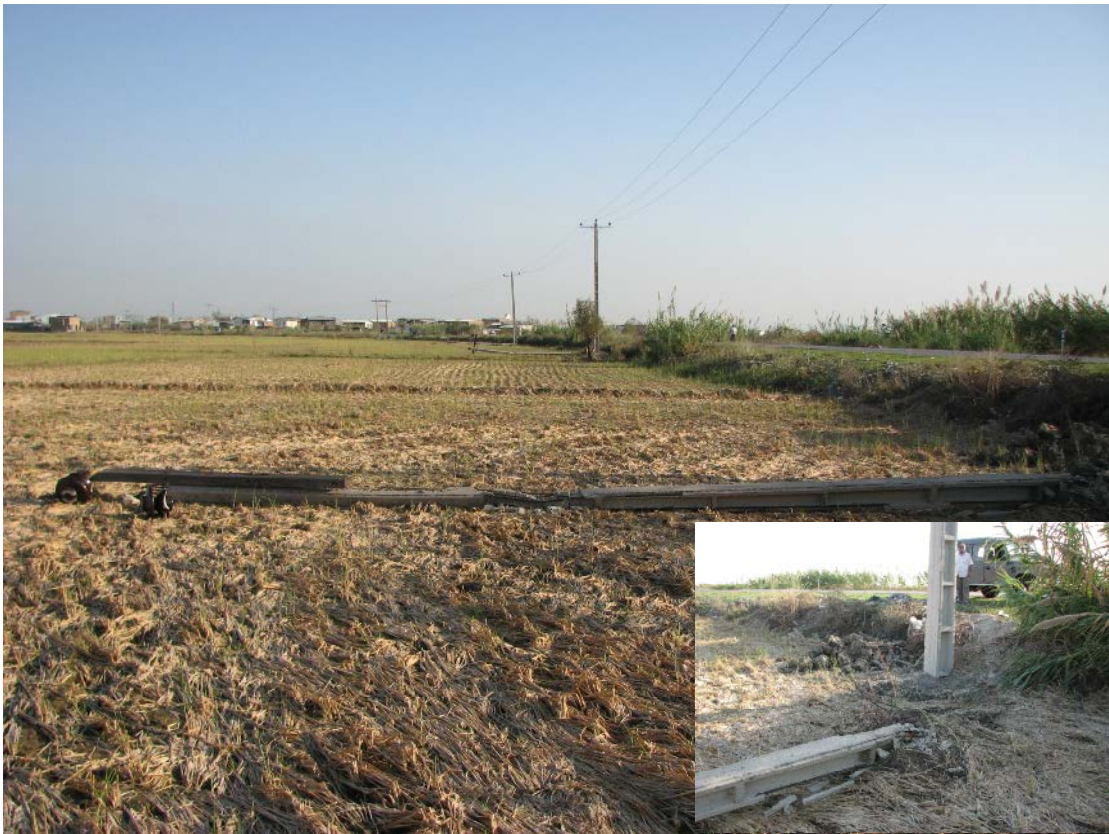
شکل ۵- شکستگی تیرهای برق حد فاصل آبادی‌های سیدمحله- عباس علی کش
