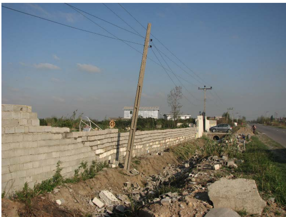
شکل ۳- تخریب دیوار خانه ویلایی بر اثر طوفان نزدیک آبادی پنبه زار کتی
