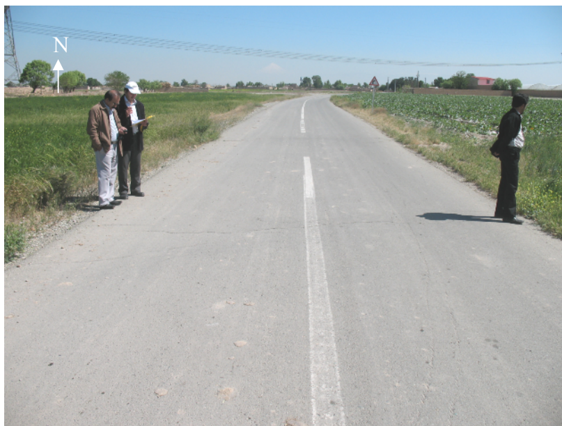
تصویر شماره ۵- نشست در جاده معین آباد - قلعه خواجه بواسطه شکاف زمین (نقطه A۴)
