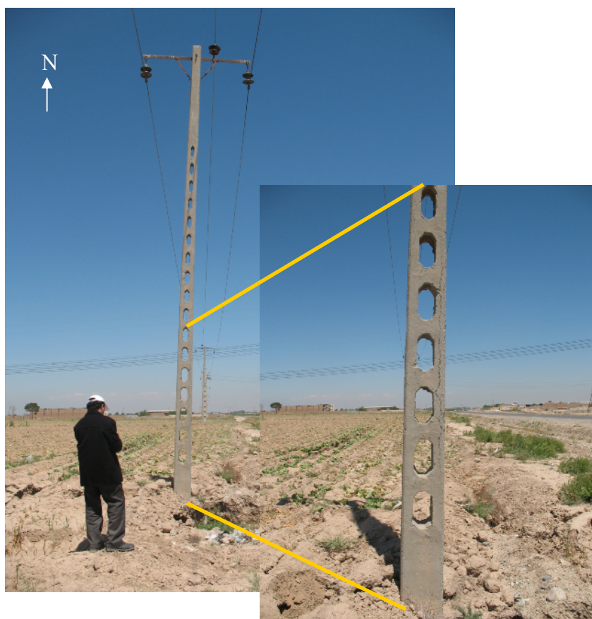
تصویر شماره ۱۲- کج شدگی تیر برق بتنی و تشکیل گودال حاصل از فرسایش آبی خاک ، ناشی از آبیاری و وجود شکاف ناشی از فرونشست زمین (A۱۵)
