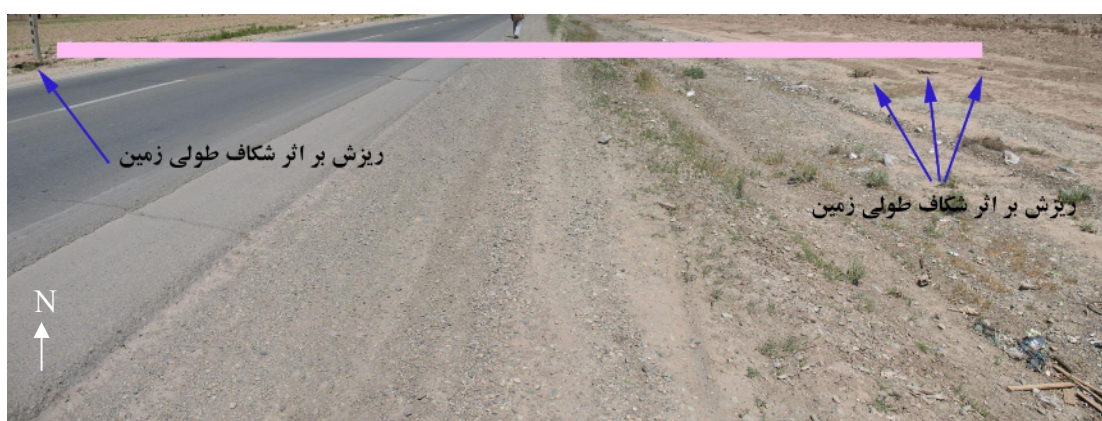
تصویر شماره ۱۱- ترک و حفرات شکاف سری A و اثر عبور آن از جاده حصارک - قلعه خواجه (خط صورتی بیانگر امتداد شکاف زمین معین‌آباد است که از عرض جاده قلعه خواجه عبور می‌کند)
