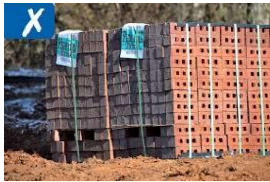
شکل ۲-۱-۲- انبار کردن نامناسب مصالح آجری در تماس با خاک
