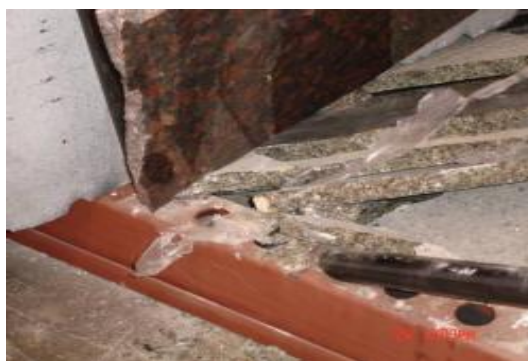
شکل ۲-۱۳-۵- شکستگی قفسه‌ها به دلیل ضعیف بودن دندانه‌ها
