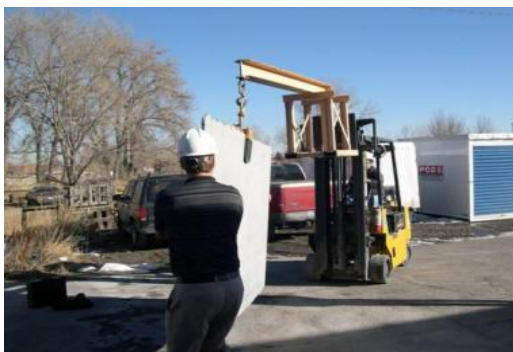
شکل ۲-۱۳-۱۰- جابجایی پلاک سنگ با استفاده از تجهیزات مکانیکی مانند جرثقیل توجه داشته باشید قبل از بستن گیره و حرکت دادن پلاک، کارکنان باید از قفل و بست آن اطمینان حاصل کنند و از قرار گرفتن در سایه سقوط در امان باشند (شکل ۲-۱۳-۱۱) [۱].
