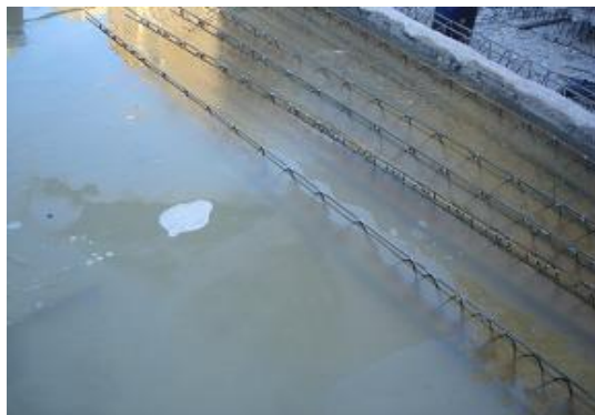
شکل ۲-۱۸-۳- یخ‌زدگی آب درون حوضچه باعث یخ‌زدگی آب نفوذ کرده درون لوله‌های مویین شده و موجب ترک‌خوردگی بتن می‌شود
